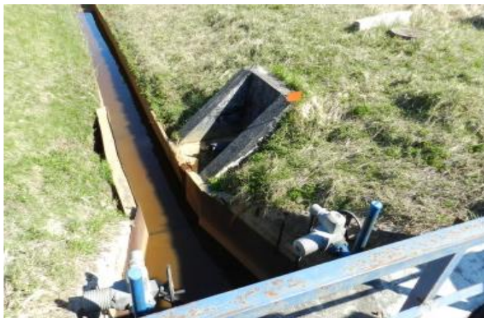
Рисунок 11. Магистральный канал. Оголовок выпуска очищенных стоков.
