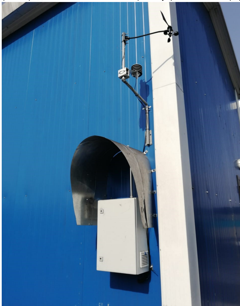
Рисунок 6.1-1. Стационарный прибор контроля за состоянием атмосферного воздуха Toras
