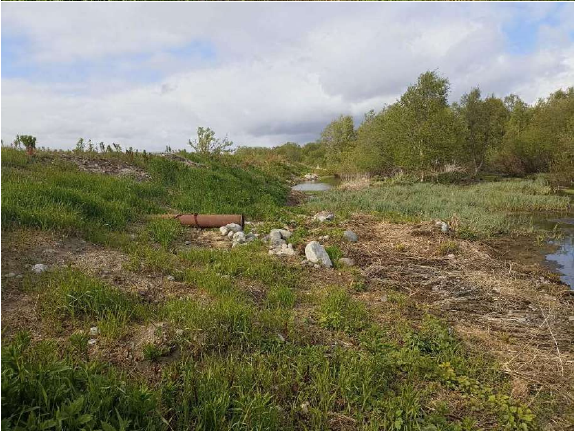
Водосбросные трубы забиты, находятся в неработоспособном состоянии.
