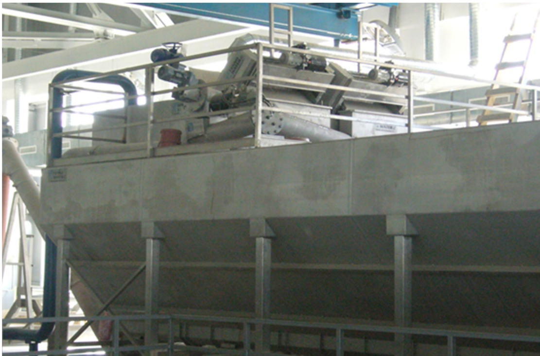
Рис. 10 – Гидравлические многоступенчатые решетки, совмещенные с песколовками
