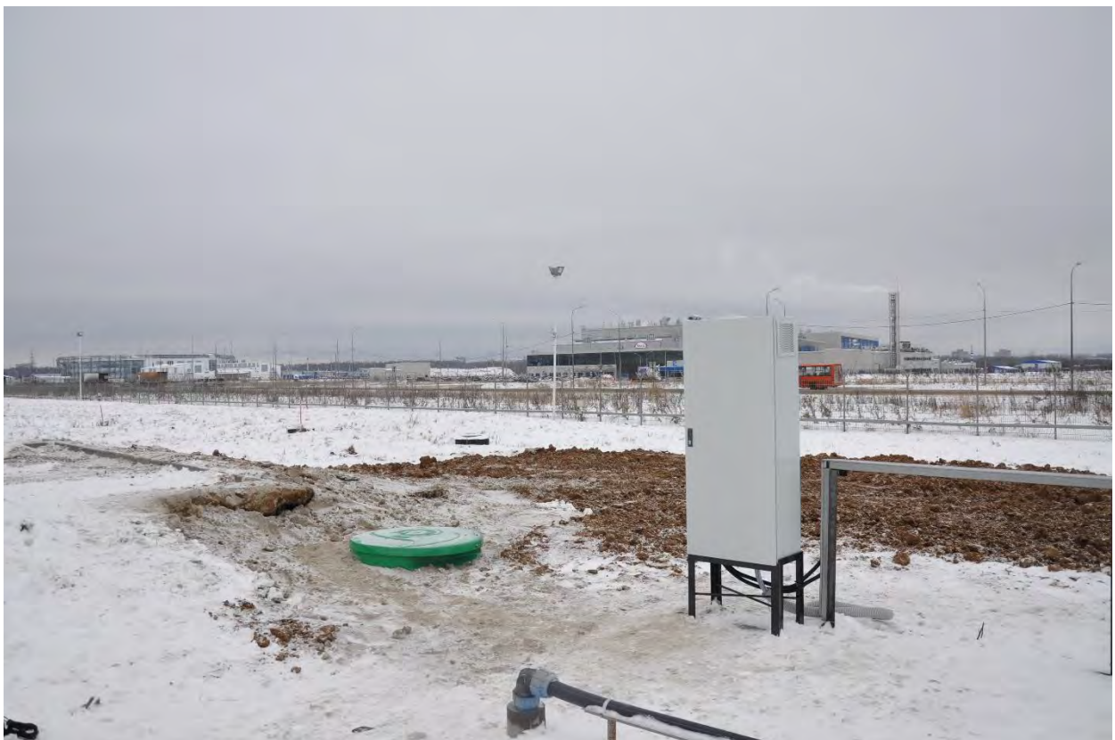
Термошкаф рядом со станцией СДВ Завод Комацу г. Ярославль
