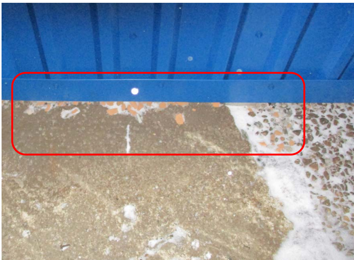
Фото 6. Высыпание кирпичной крошки из-под обшивки стен.
