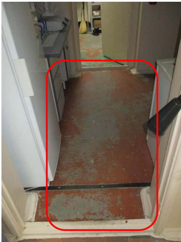
Фото 3. Истирание покрытия пола в ходовых местах.
