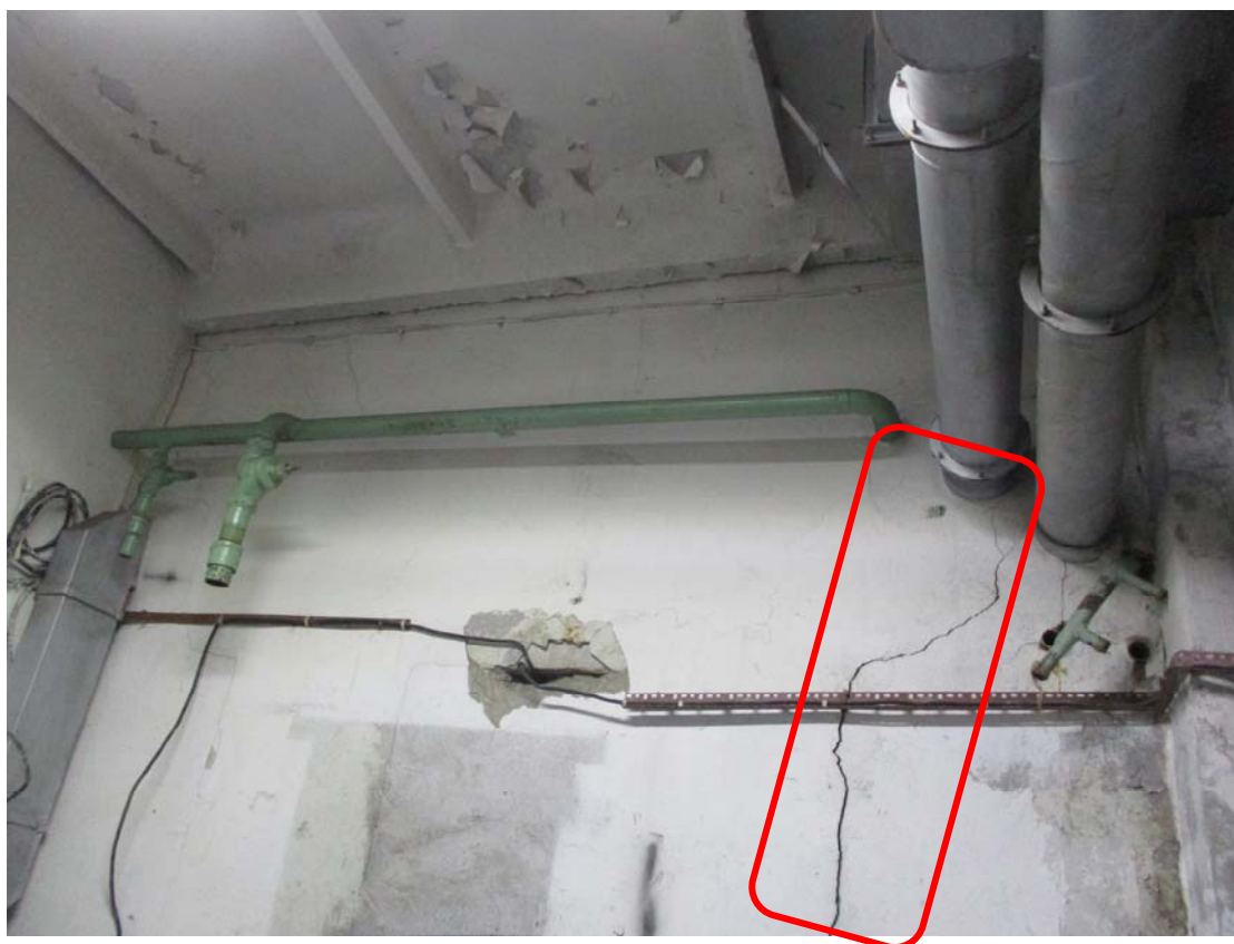
Фото 4. Трещина в стене по оси 8 шириной раскрытия до 5 мм..
