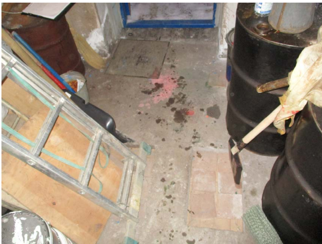
Фото 2. Разрушение покрытия пола в осях 8-9.
