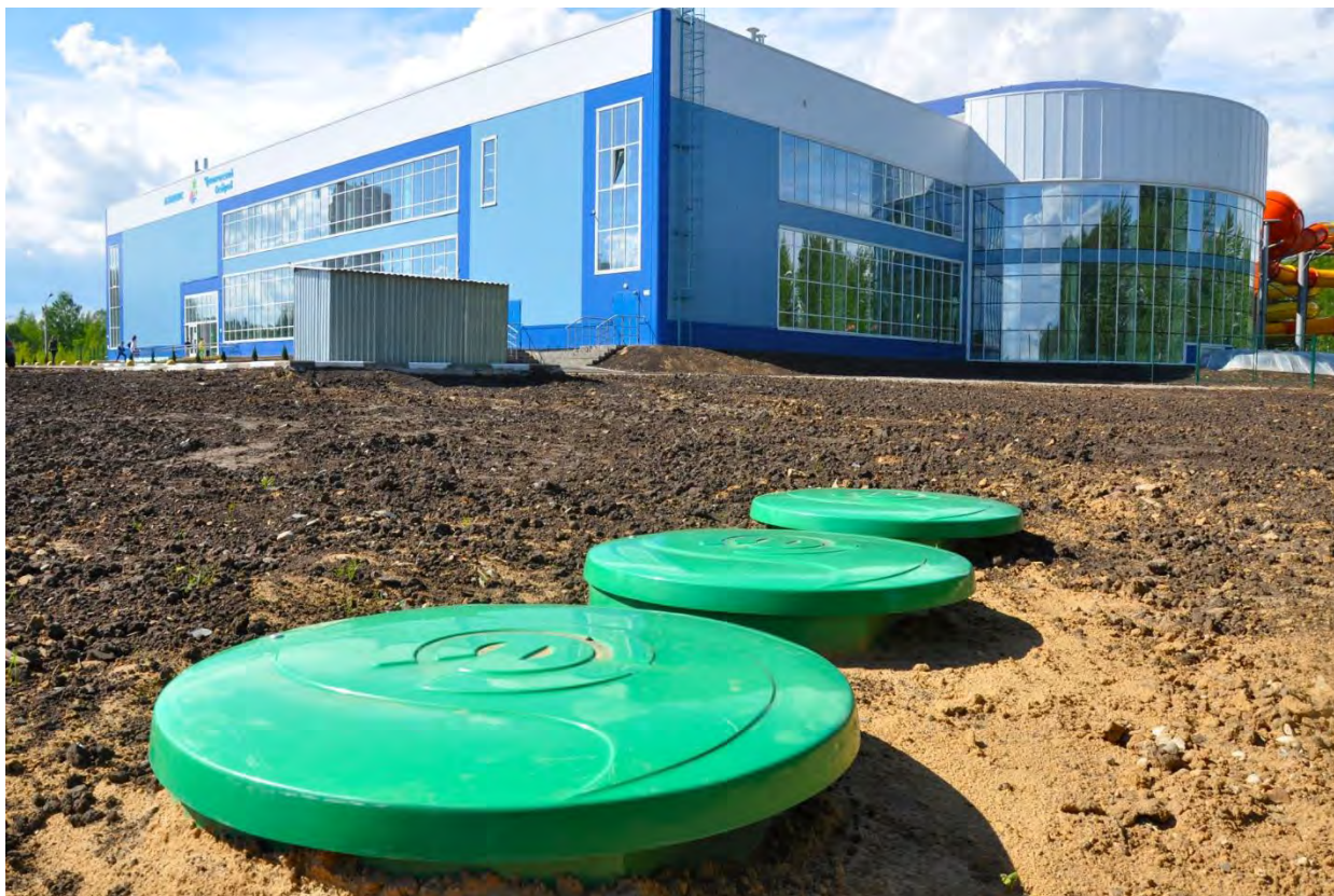
Смонтированная установка Векса-М (Аквапарк, г. Ярославль)
