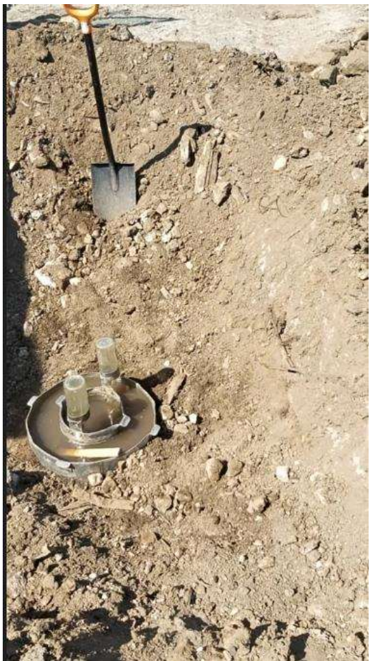
Рисунок 1.1.8 – Выполнение налива в шурф в грунтах ТГ-5 в восточной части участка работ
