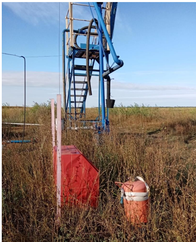
Рис.5.1.4 Площадка налива нефти
