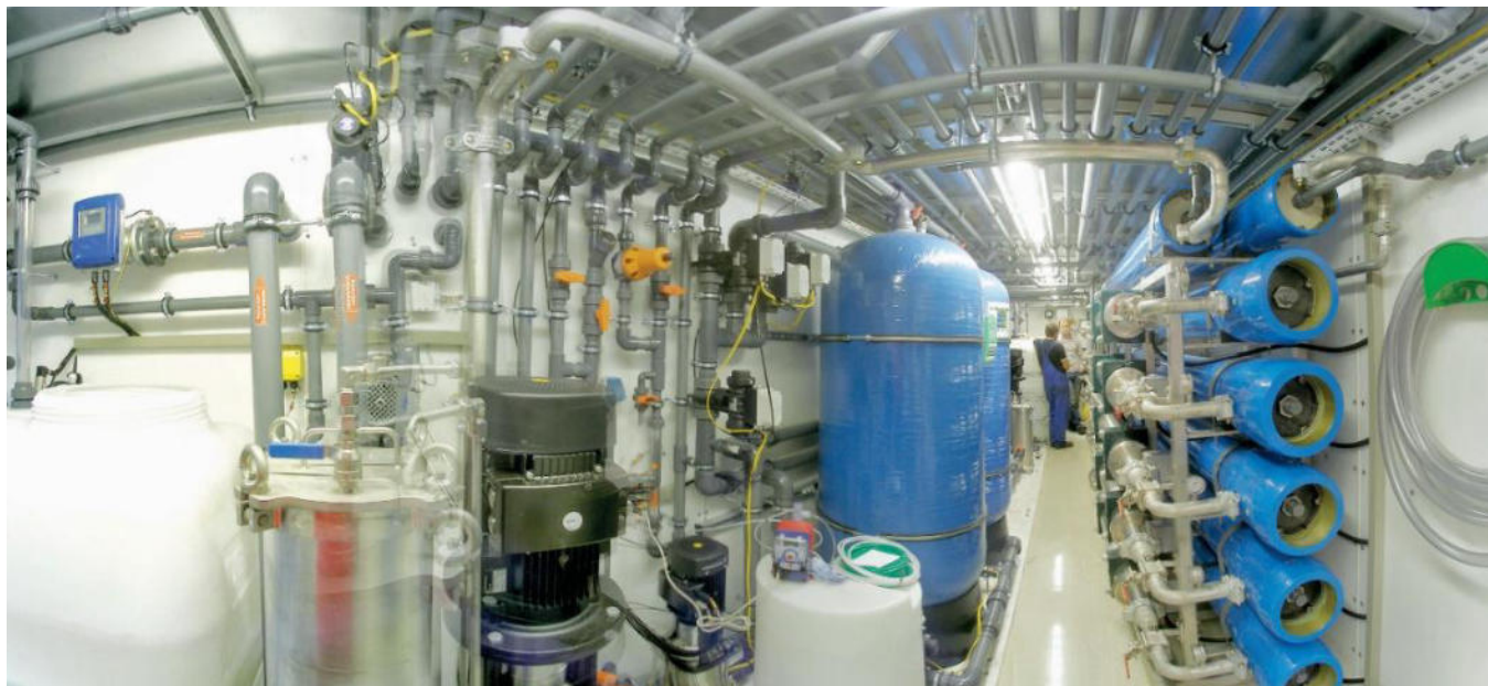
Рис.2.3.10. Внутренне устройство установки очистки фильтрата с применением технологии обратного осмоса.
