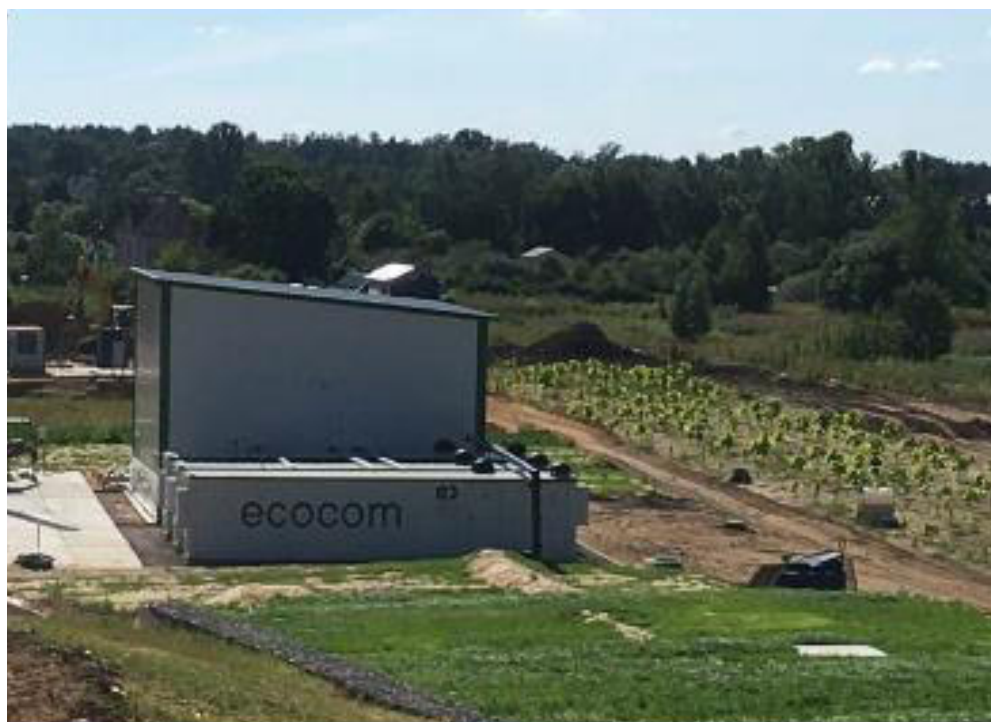
Рис. 2.3.9. Площадка очистных сооружений фильтрата с установками обратного осмоса.
