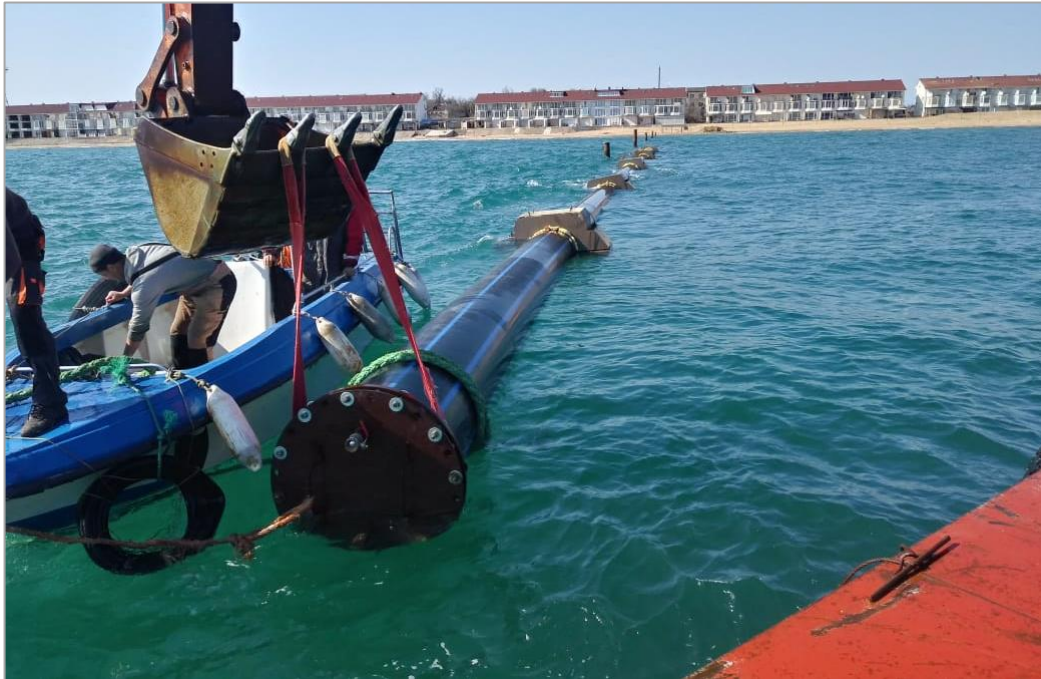
Рисунок 2.4.3 – Затопление секции трубопровода
