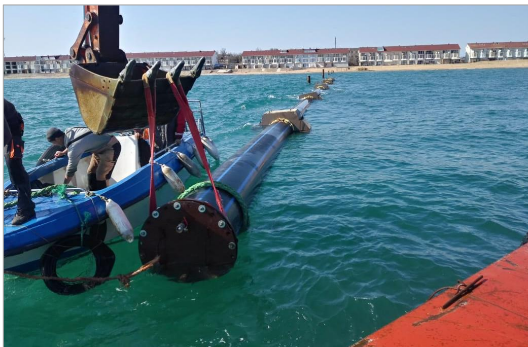
Рисунок 2.4.3 – Затопление секции трубопровода
