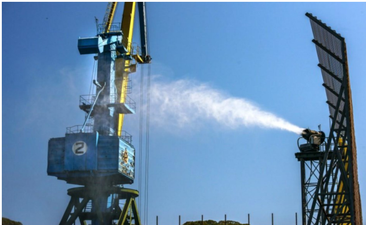
Рисунок 18.4.6 - Стационарные системы пылеподавления
