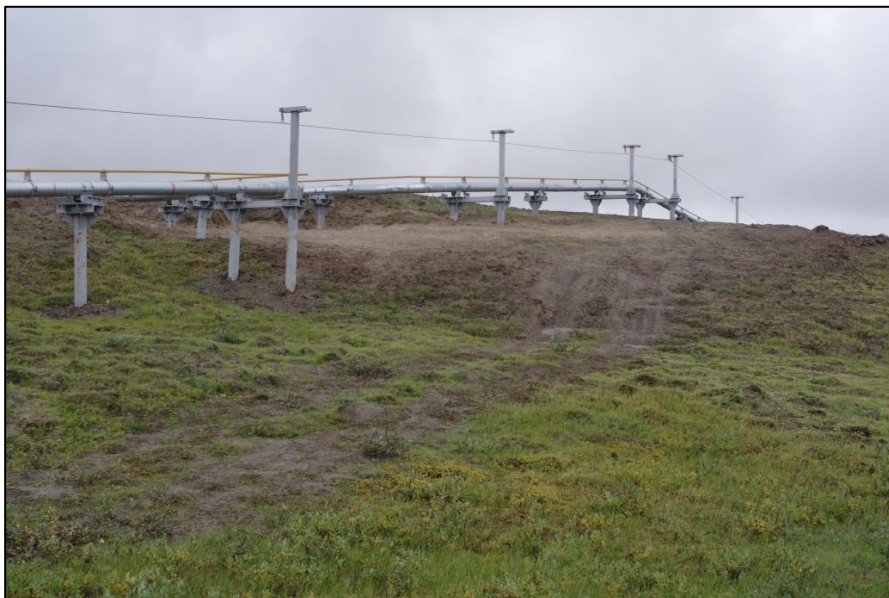
Рисунок 9.6.4: Деградированная растительность в полосе отвода метанолопровода на левом борту долины р. Халцуней-Яха
