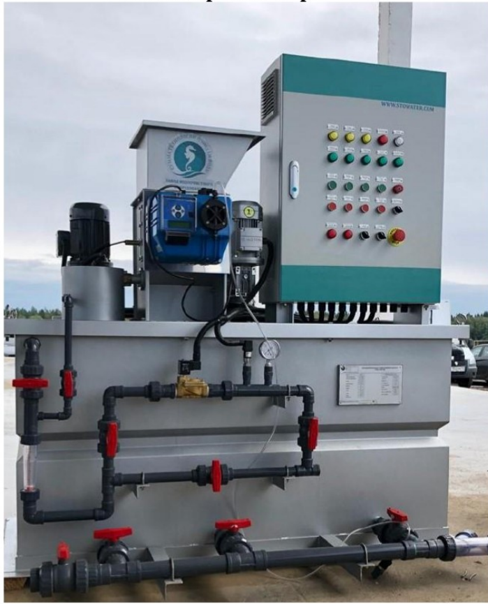
Рис.8 Установка автоматического приготовления и дозирования флокулянта
