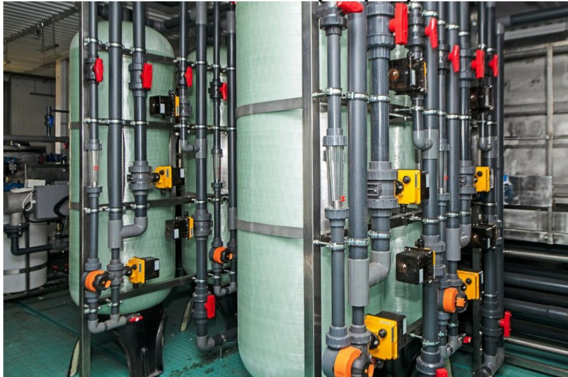
Рис.11 Установка напорных фильтров
