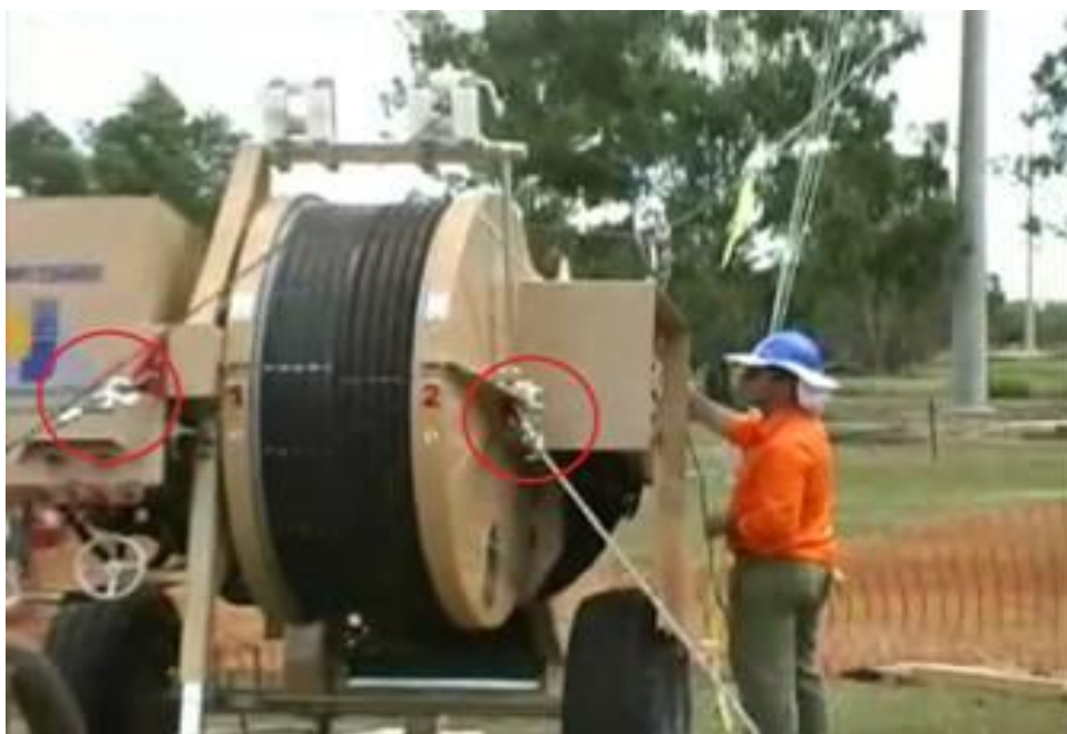
Рисунок 8.10 – Установка тормозной машины – точки крепления якоря к тормозной машине с помощью стального троса
