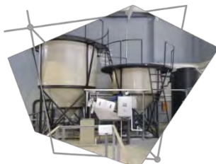
Электродепо «Южное» Очистные сооружения Санкт-Петербург
