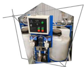
Электродепо «Невское» Очистные сооружения Санкт-Петербург
