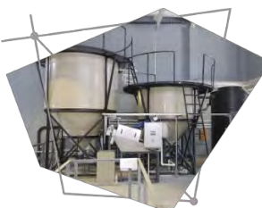
Электродепо «Южное» Очистные сооружения Санкт-Петербург
