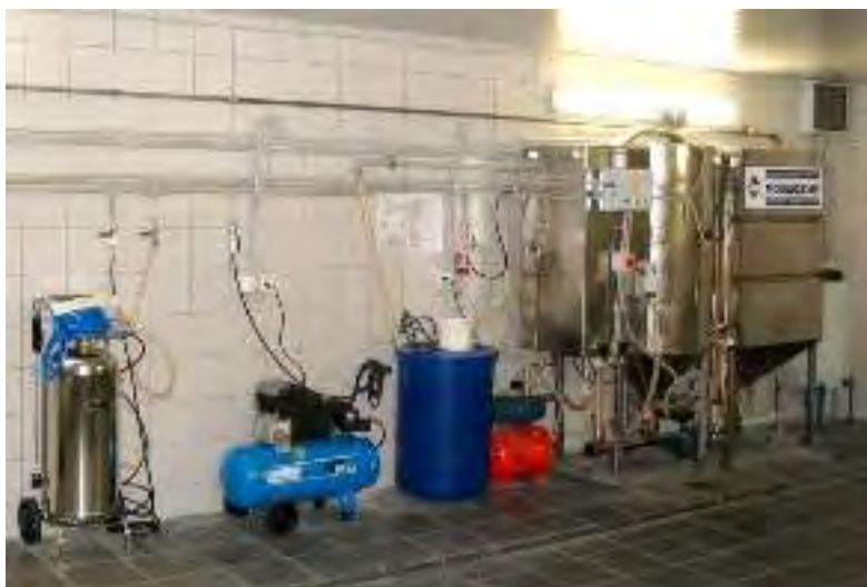
Технологическое оборудование мойки с очистной установкой
