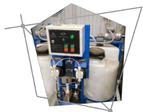
Электродепо «Невское» Очистные сооружения Санкт-Петербург
