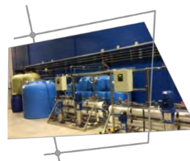
Завод по производству водонагревателей «Термекс» Очистные сооружения Лен.обл., г. Тосно
