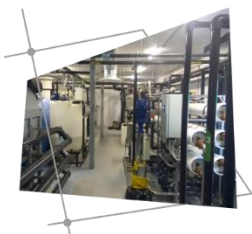
Северный поток-2 Очистные сооружения Лен. обл., Кингисеппский р-н
