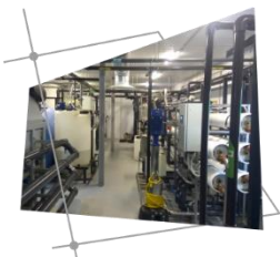
Северный поток-2 Очистные сооружения Лен. обл., Кингисеппский р-н
