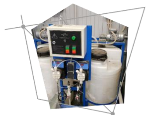
Электродепо «Невское» Очистные сооружения Санкт-Петербург
