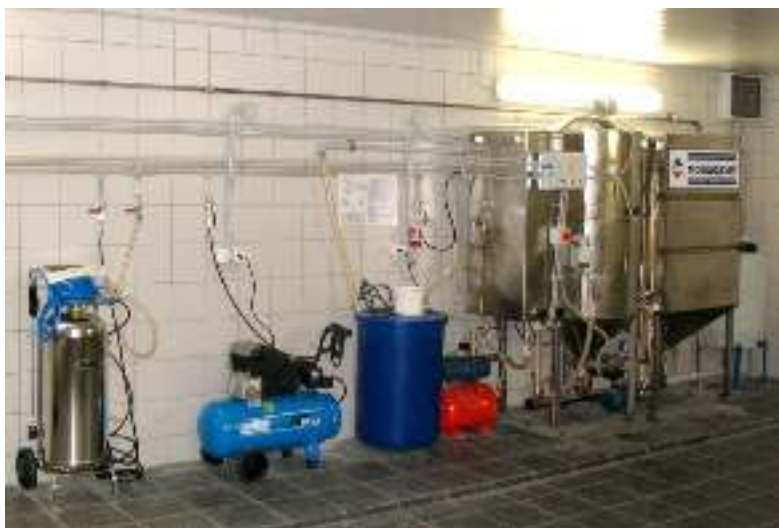
Технологическое оборудование мойки с очистной установкой
