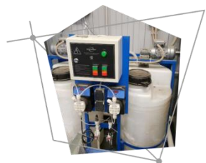
Электродепо «Невское» Очистные сооружения Санкт-Петербург
