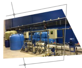
Завод по производству водонагревателей «Термекс» Очистные сооружения Лен.обл., г. Тосно
