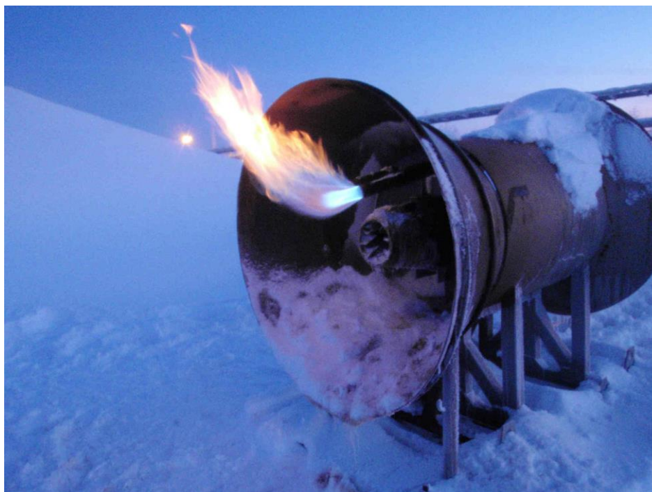
Рисунок 2.3-2. Горизонтальная факельная установка
