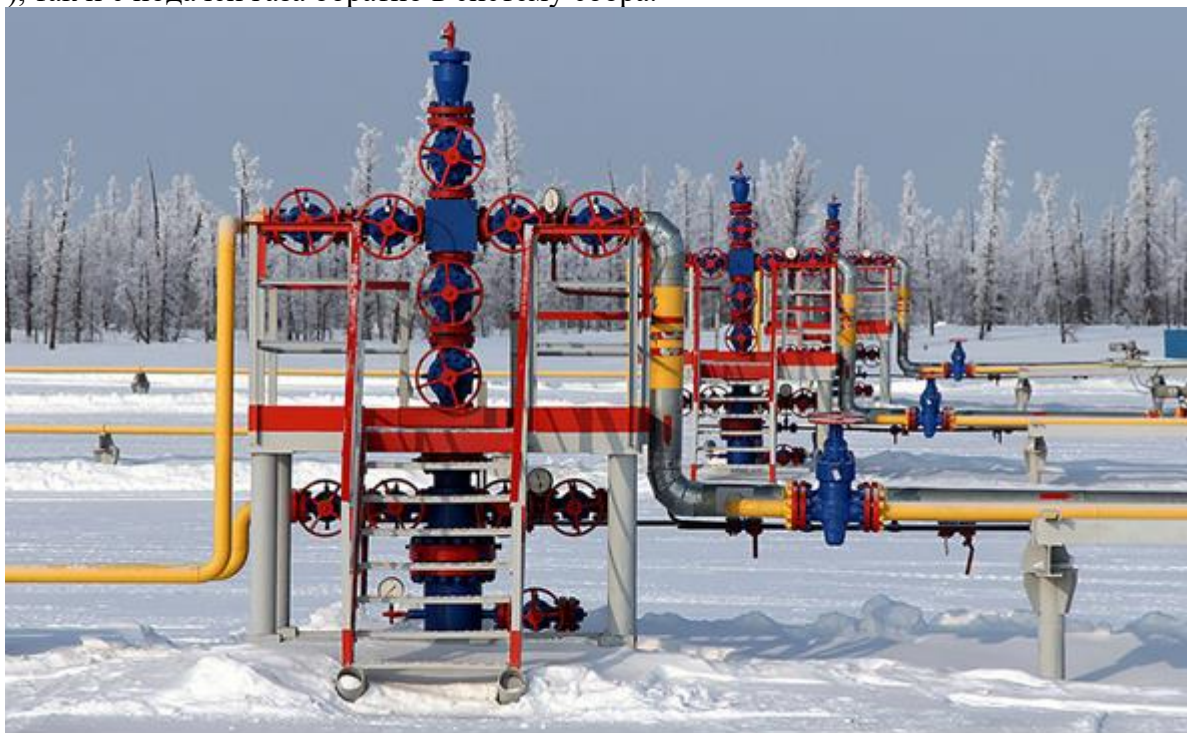
Рисунок 2.3-1. Газовая скважина. Фонтанная арматура.
