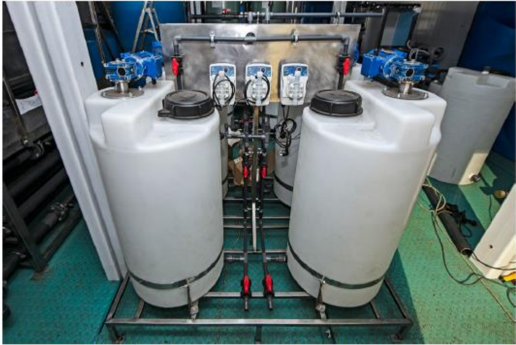
Рис.4 Установка приготовления и дозирования реагента
