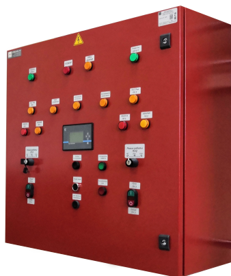
Пример шкафа, управления на два насоса
