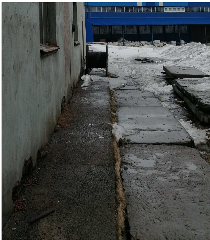
Рисунок 12 – Бетонный лоток с электрическими кабелями
