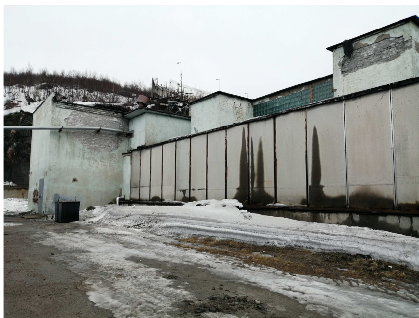
Рисунок 6 – Служебно-техническое здание с блоком емкостей
