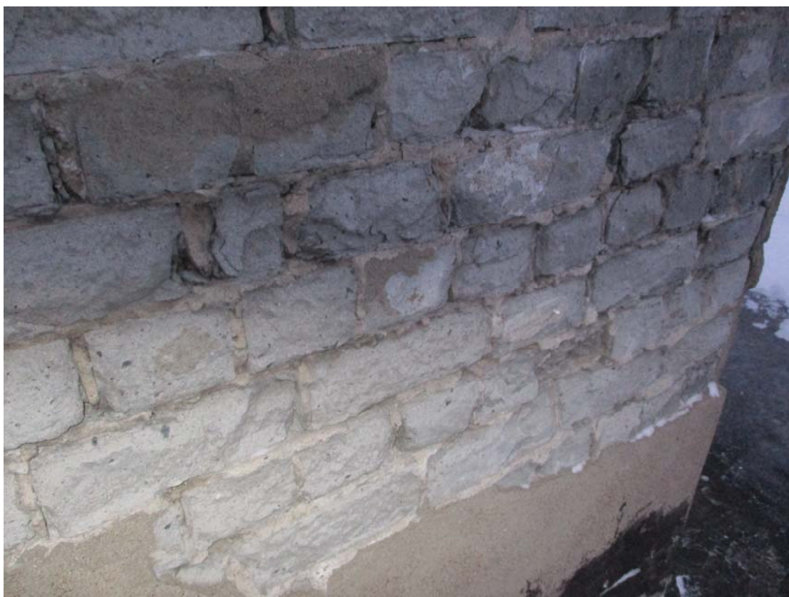
Фото 12. Разрушение наружного слоя кладки стены технического коридора на глубину до 40 мм.
