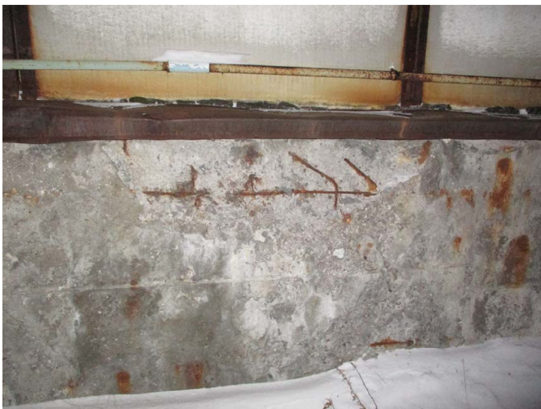
Фото 4. Разрушение защитного слоя бетона с оголением и коррозией армирования цокольной части блока емкостей.
