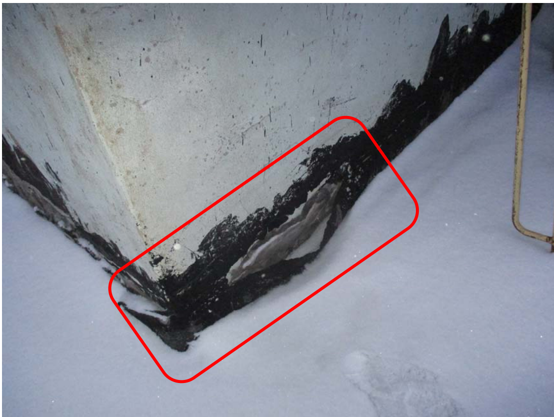
Фото 15. Разрушение примыканий гидроизоляционного ковра к стенам технического коридора.
