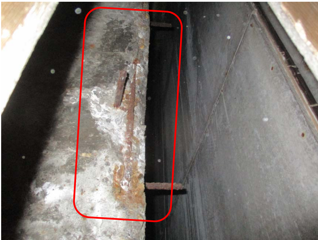
Фото 11. Разрушение защитного слоя бетона стены блока емкостей на пересечении осей 7/Г с оголением и коррозией армирования.
