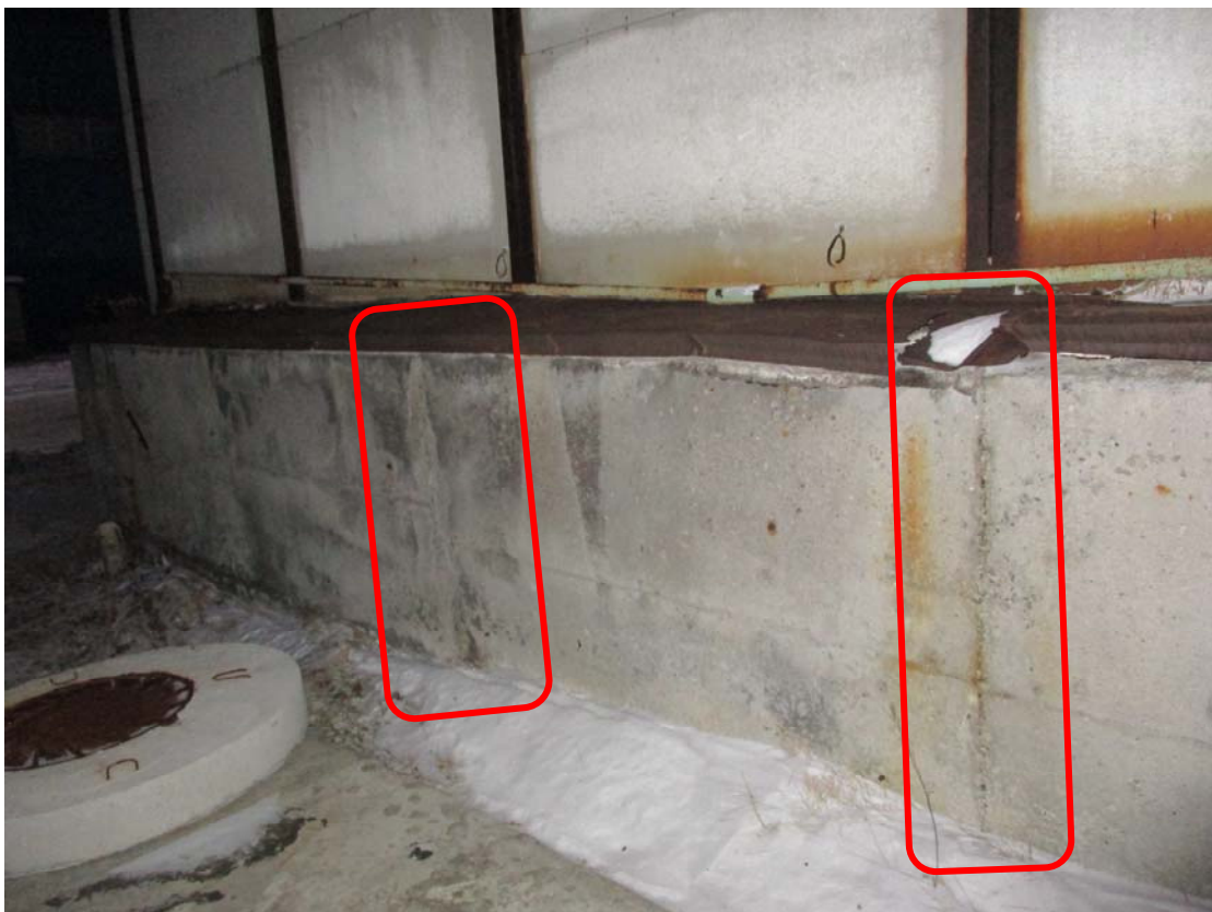
Фото 6. Трещины в цокольной части блока емкостей шириной раскрытия до 2 мм. Сквозная коррозия отлива цоколя.
