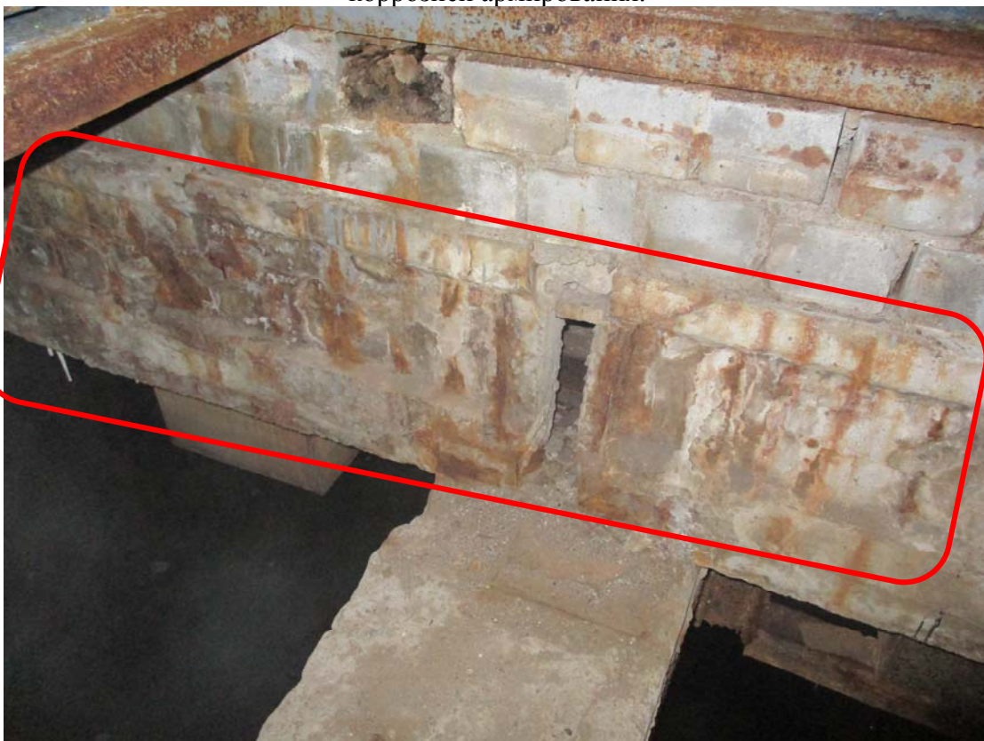
Фото 10. Разрушение защитного слоя бетона плит перекрытия блока емкостей с оголением и коррозией армирования.
