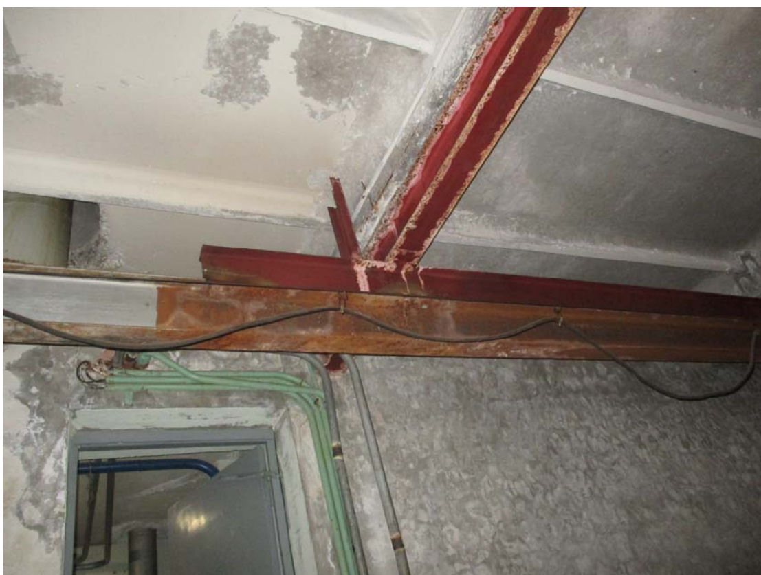
Фото 8. Разрушение отделки плит покрытия.
