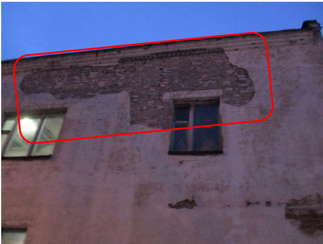
Фото 3. Разрушение отделки стен.
