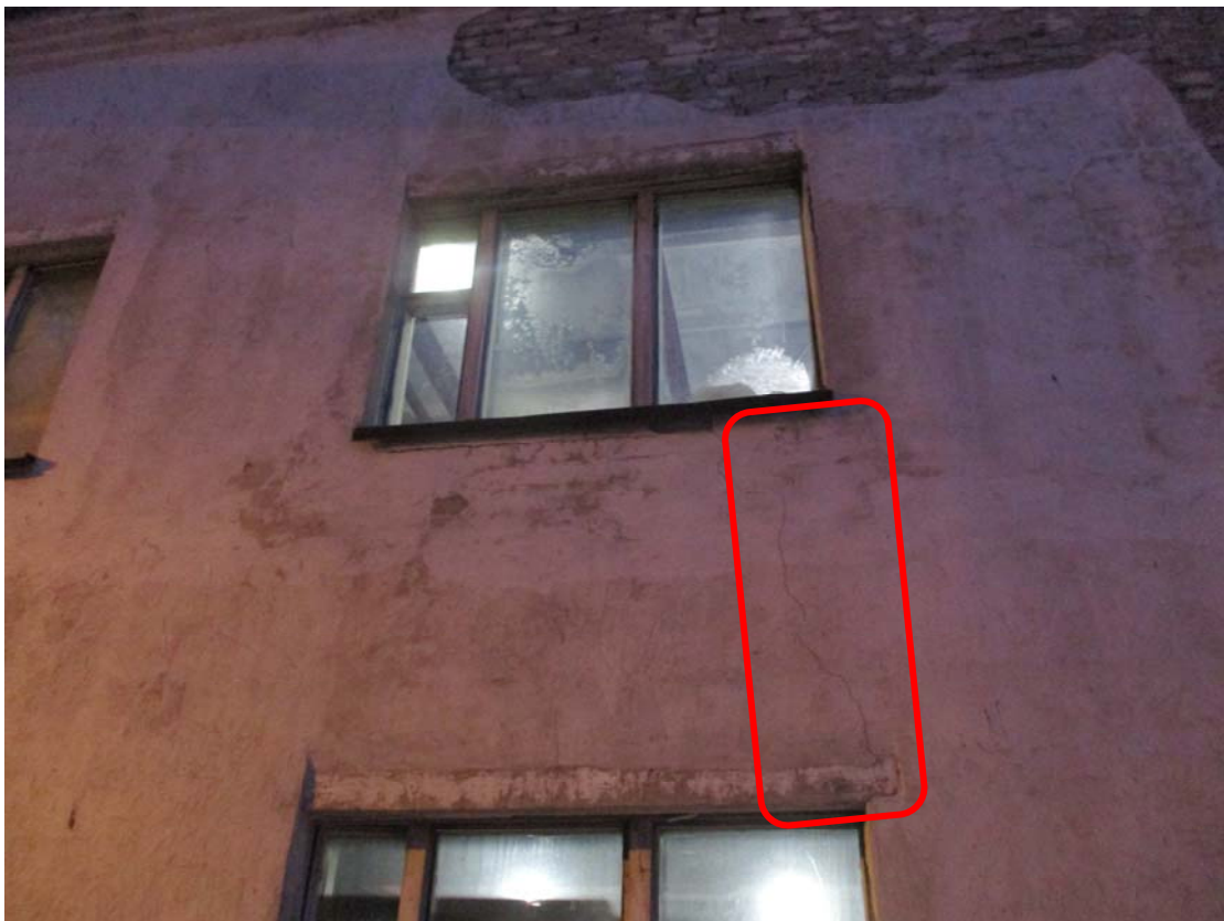
Фото 5. Трещины в стенах шириной раскрытия до 2 мм.
