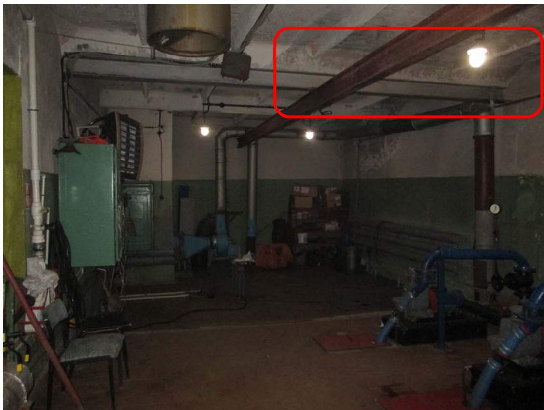
Фото 6. Общий вид помещения насосной. Повреждение отделки плит покрытия.
