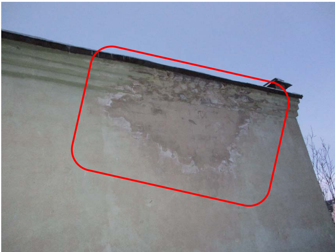
Фото 3. Разрушение отделки стены. Недостаточный карнизный свес.
