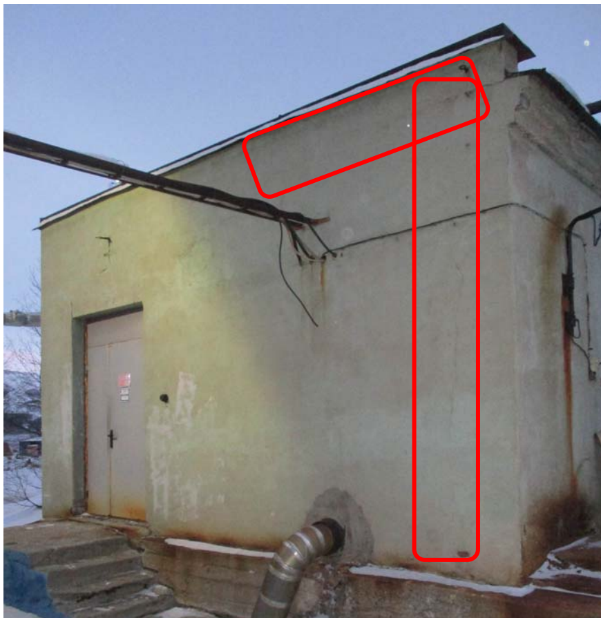
Фото 5. Вертикальные и горизонтальные трещины в стенах шириной раскрытия до 2 мм.
