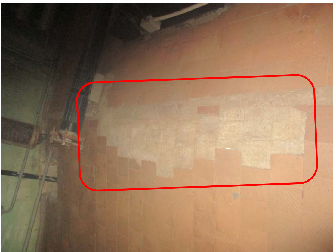
Фото 4. Разрушение покрытия пола из метлахской плитки.
