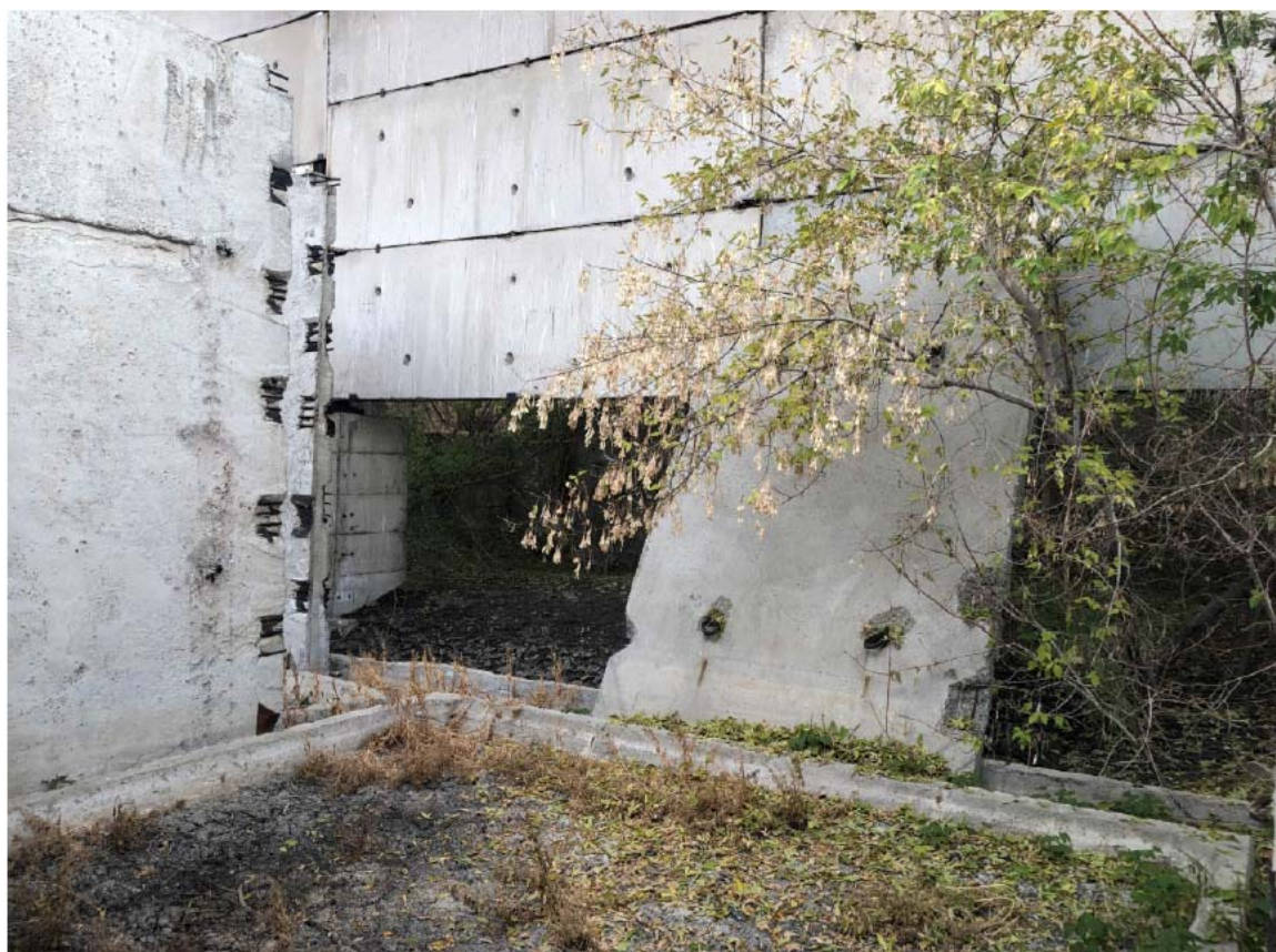
Фото 17 – Техническое состояние панели емкостного сооружения в осях «1-3».
