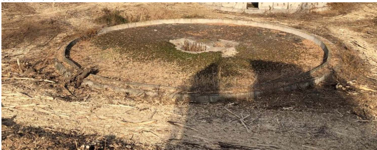
Фото 32 - Общий вид илоуплотнителя №3 в осях «3-7».
