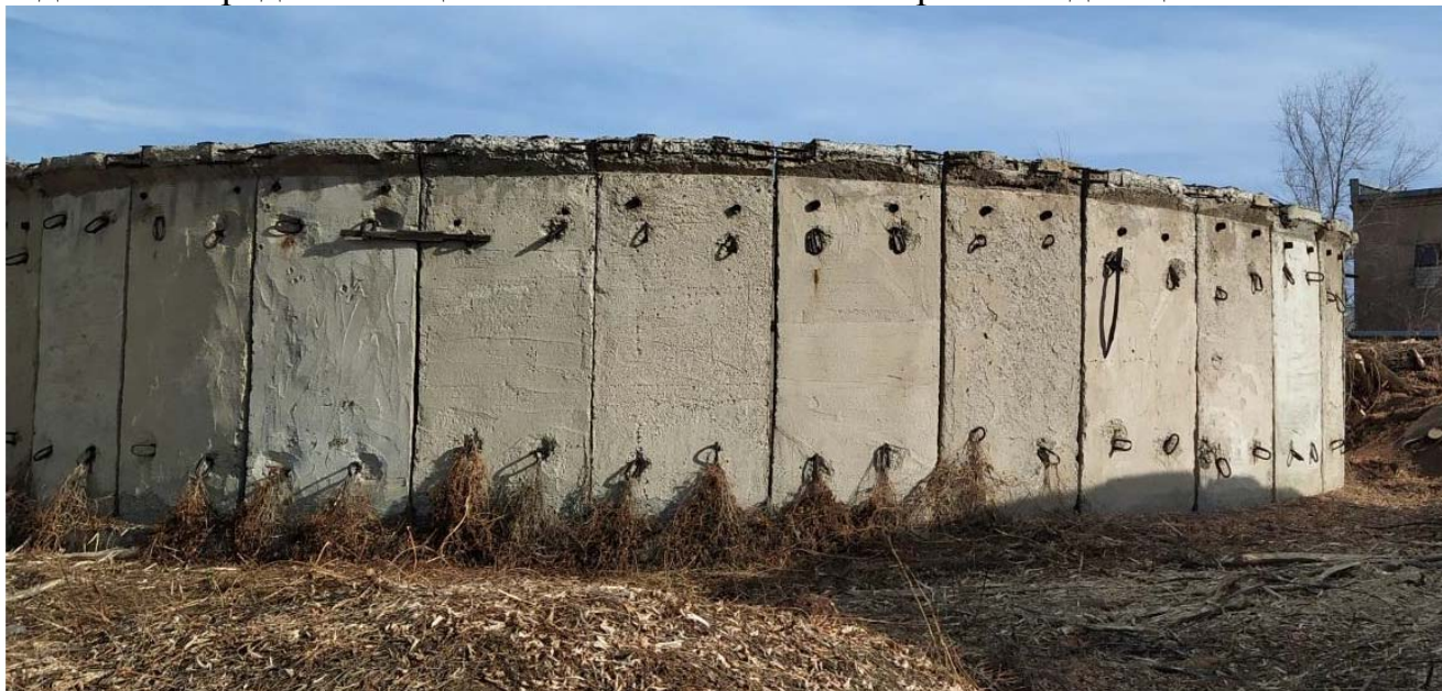
Фото 28 - Общий вид илоуплотнителя №1 в осях «2-6».
