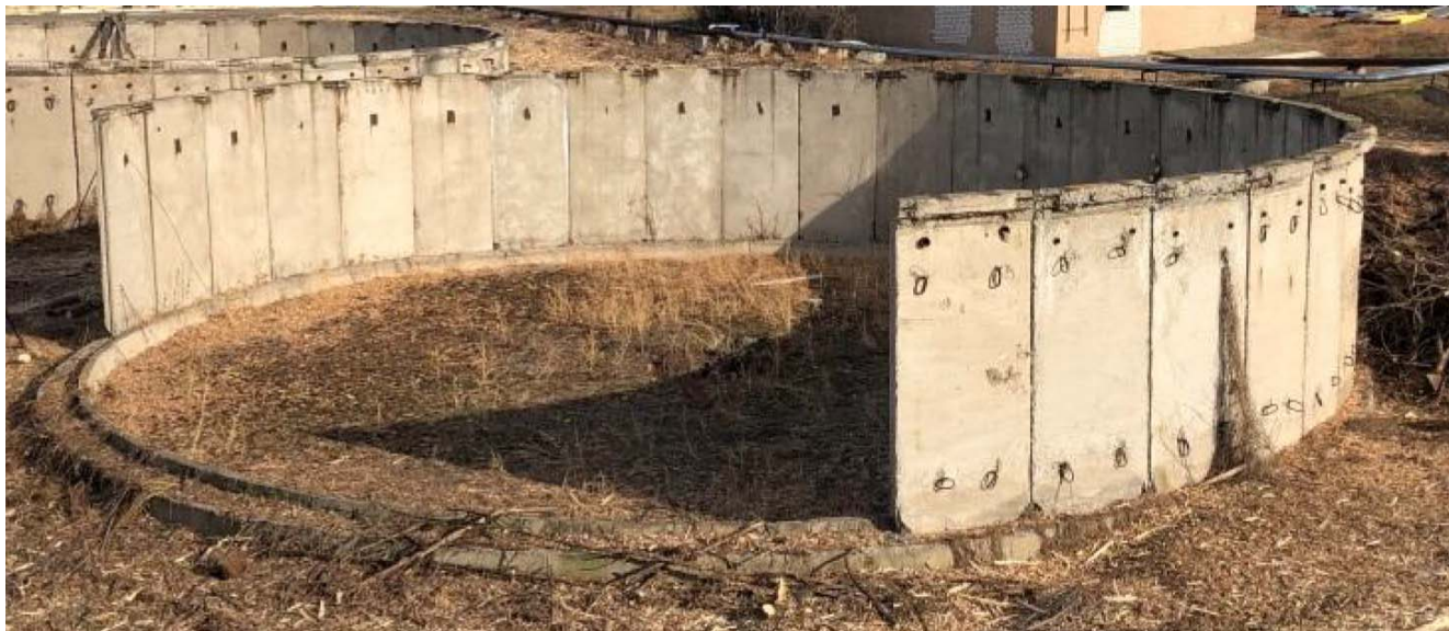
Фото 30 - Общий вид илоуплотнителя №2 в осях «2-6».
