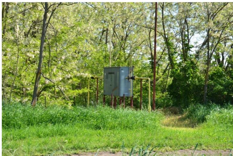
Рисунок 5.10 - Газопровод обеспечивающий централизованное газоснабжение ст-ца Новоромановская
