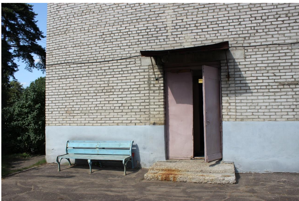
Фото А.24. Прогиб металлического козырька над входом по оси «А»
