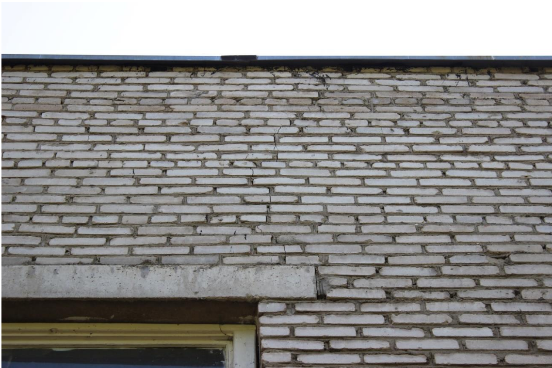
Фото А.31. Сквозная трещина в наружной стене по оси «Д»
