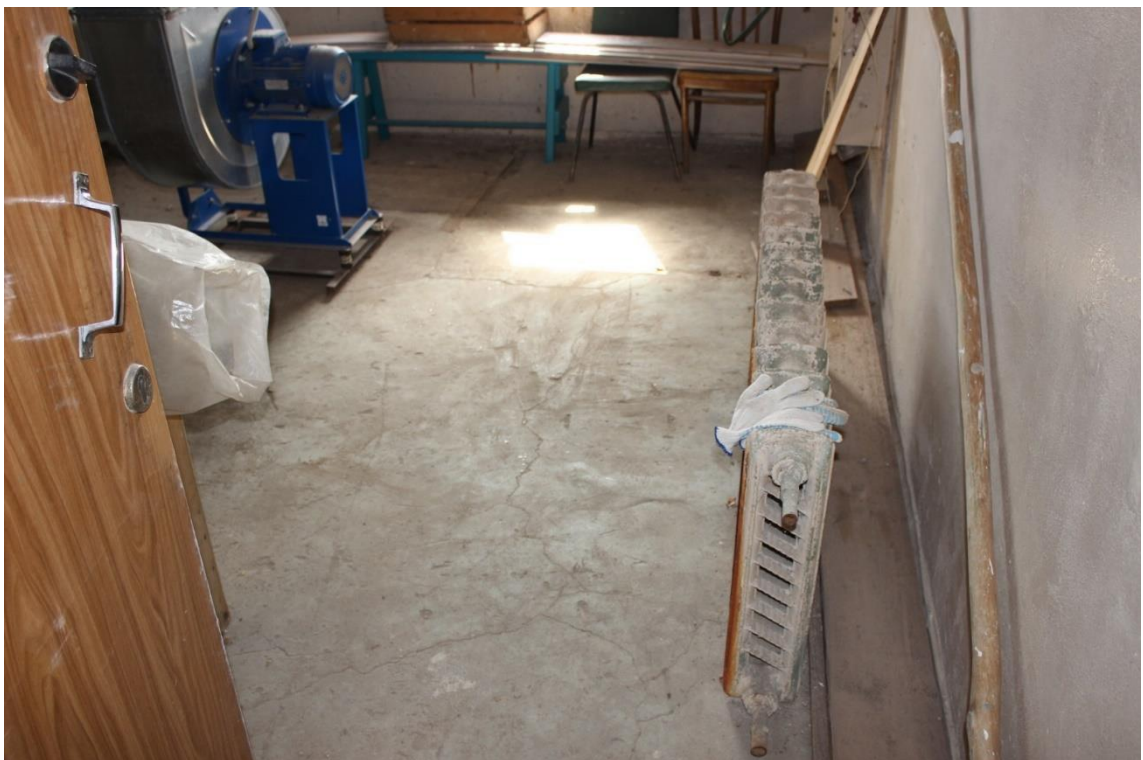
Фото 6. Общий вид состояние пола, трещины, сколы
