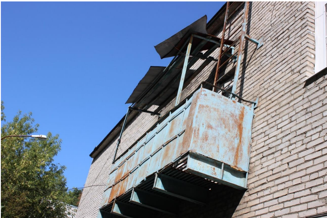
Фото А.34. Отсутствие закрепления листов покрытия балкона
