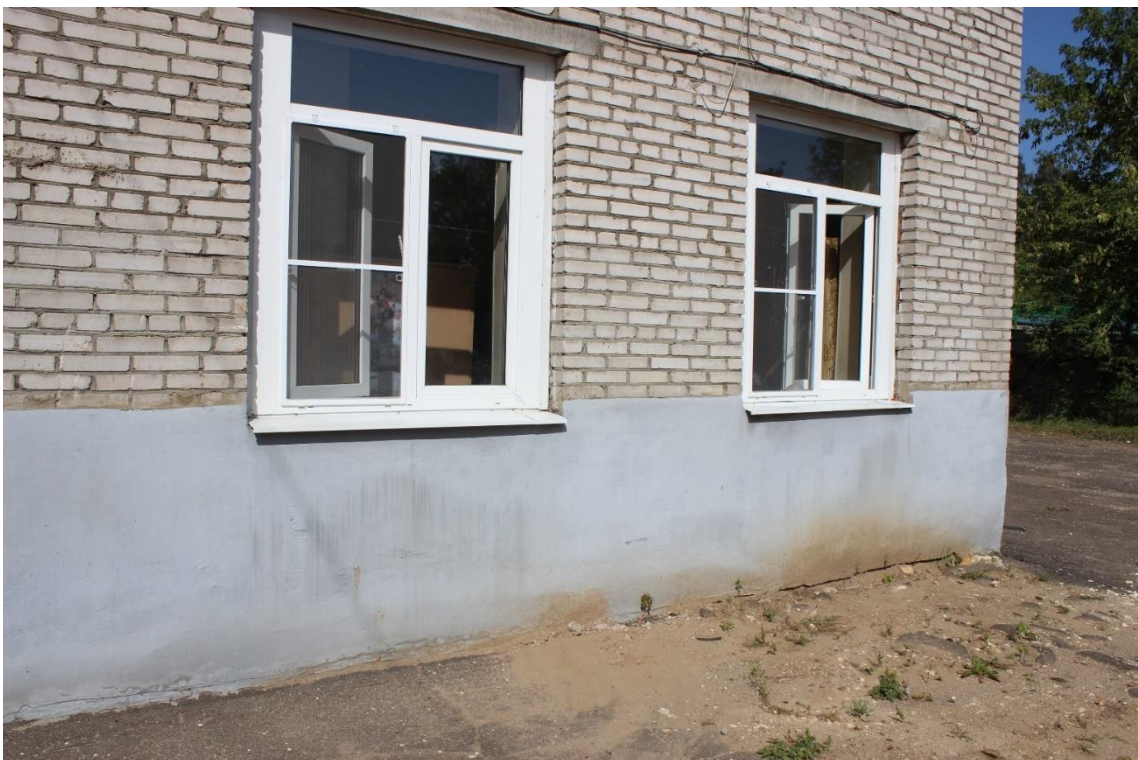
Фото А.26. Отсутствие отмостки
