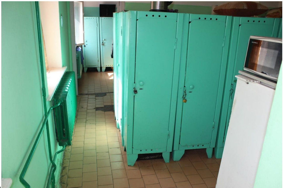
Фото А.4. Техническое состояние пола. Разрушение кафельной плитки
