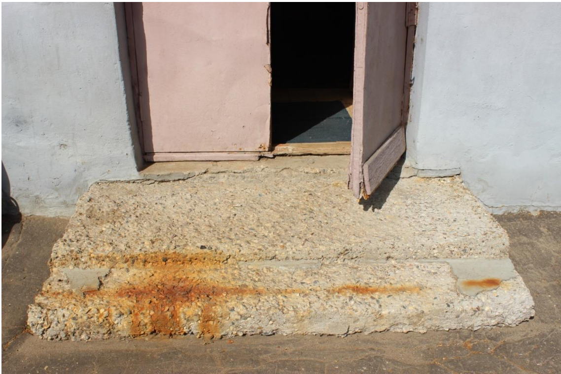
Фото А.25. Локальные разрушения бетона ступеней перед входом
