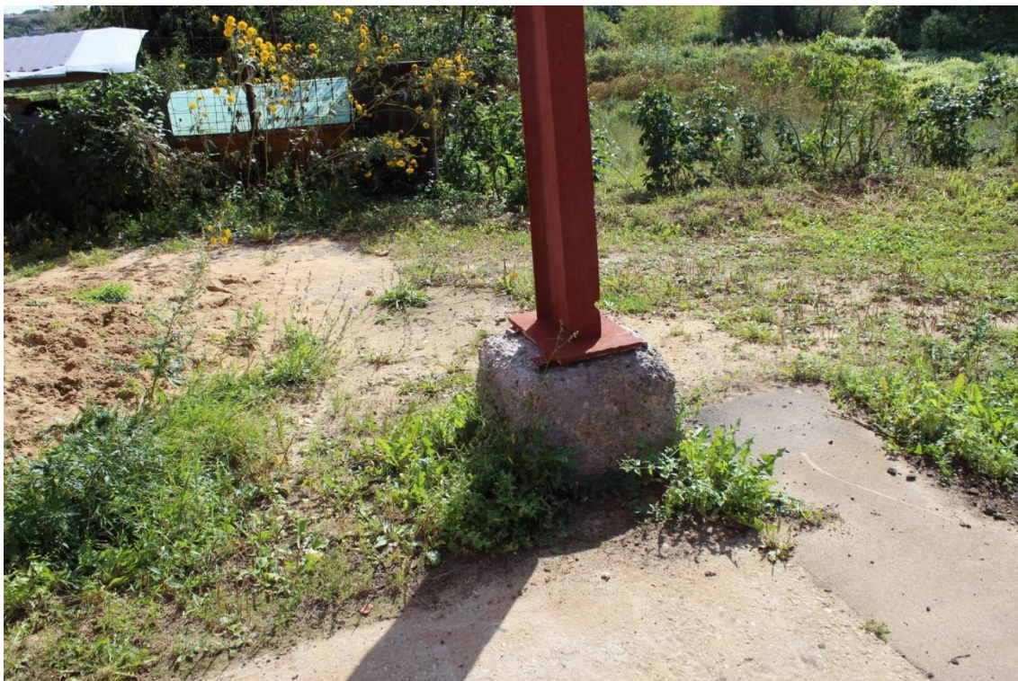
Фото 17. Разрушение бетона железобетонного фундамента под опорную раму
