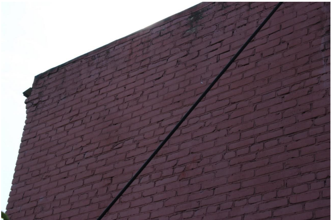
Фото 25. Отсутствие карнизных водоотводящих устройства. Замачивание кладки
