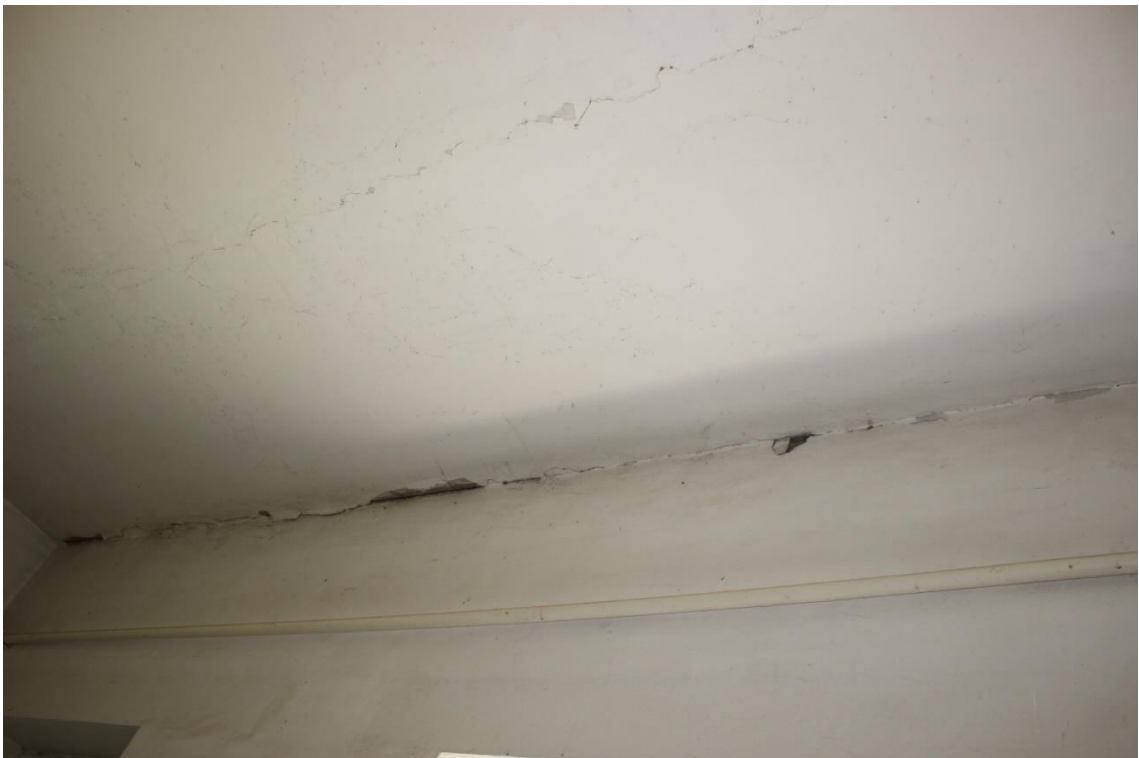
Фото А.8. Трещина в месте сопряжения плиты покрытия и наружной стены
