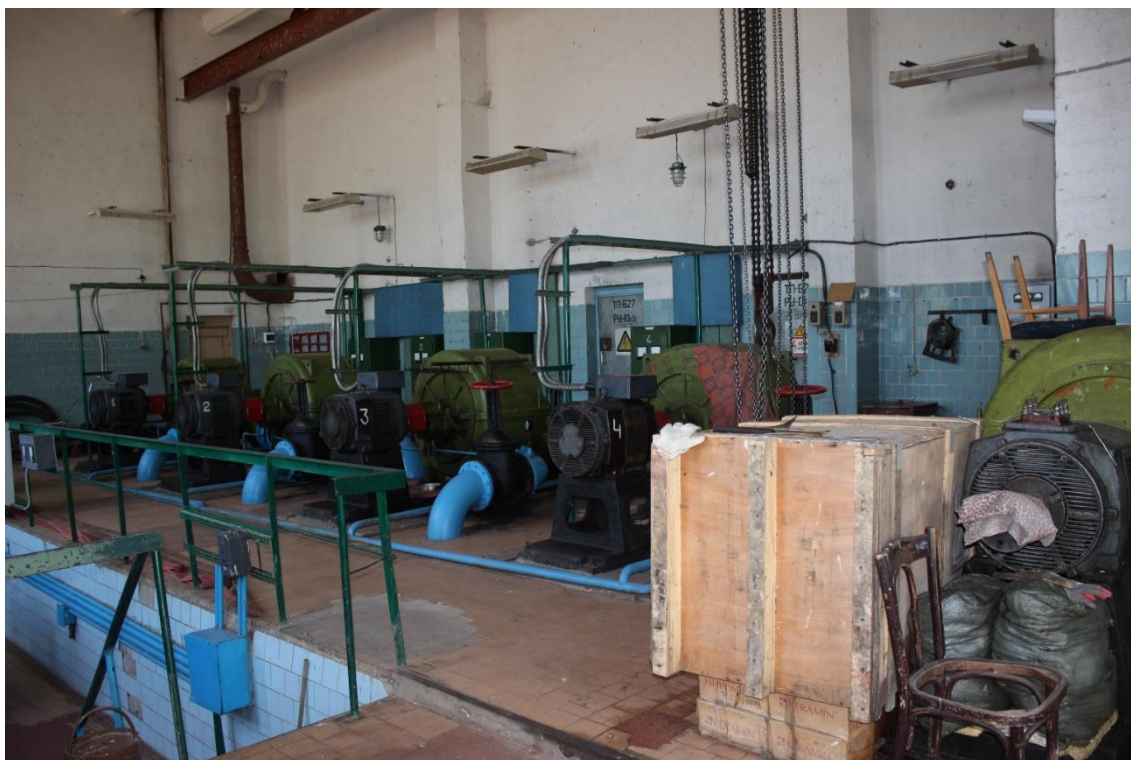
Фото А.19. Расположение технологического оборудования
