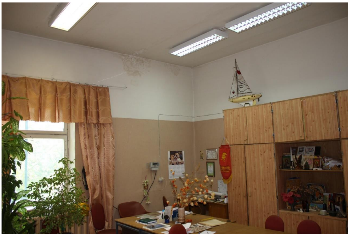
Фото А.5. Следы замачивания внутренних строительных конструкций
