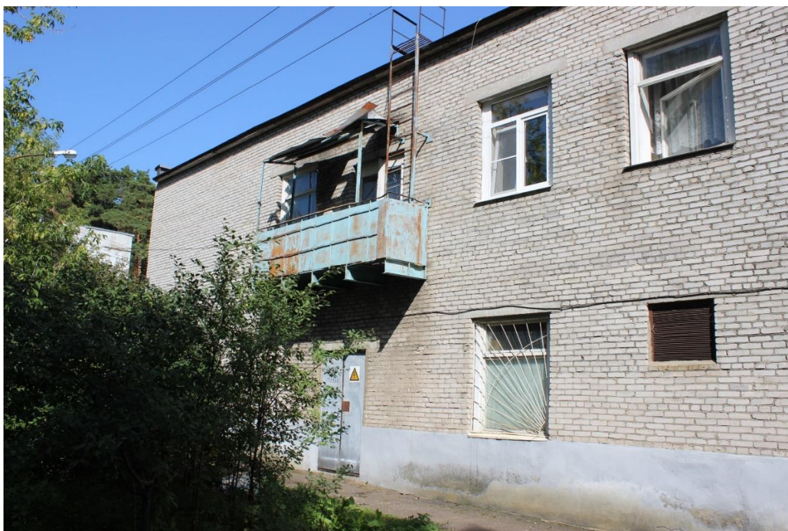
Фото А.34. Коррозионные и механические повреждения металлических элементов балкона по оси «1»
