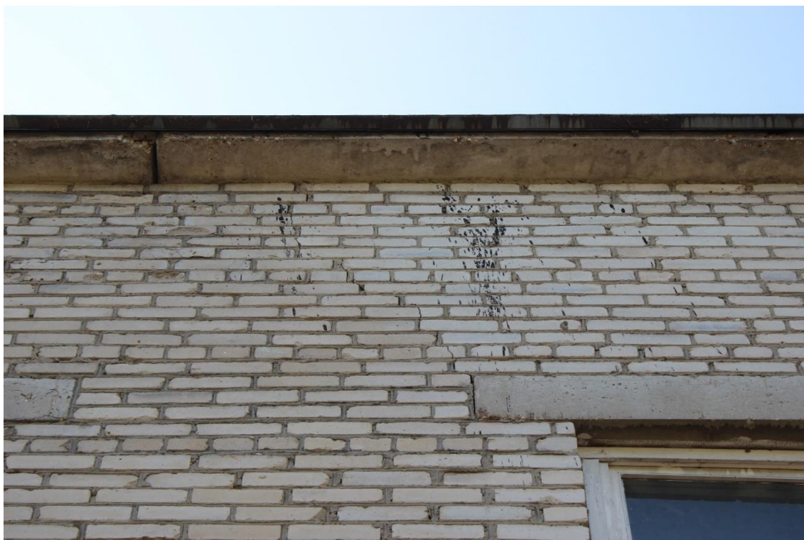
Фото А.29. Трещина в кирпичной стене по оси «4»
