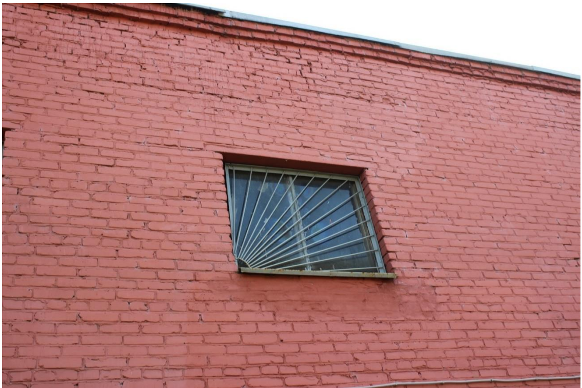
Фото 27. Локальные разрушения кирпичной кладки в карнизной части
