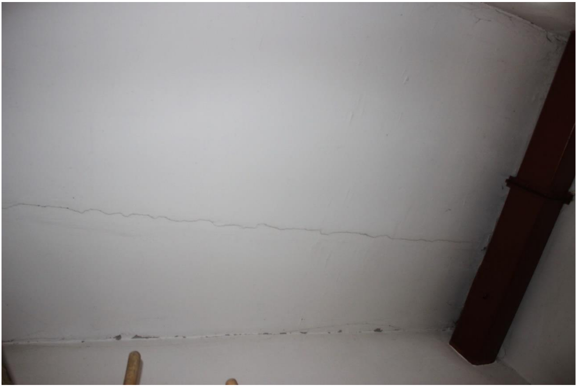
Фото А.3. Локальные разрушения отделочного слоя в швах между плитами
