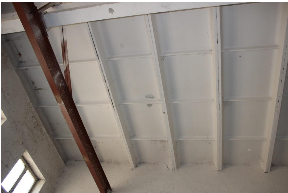
Фото А.16. Техническое состояние плит покрытия
