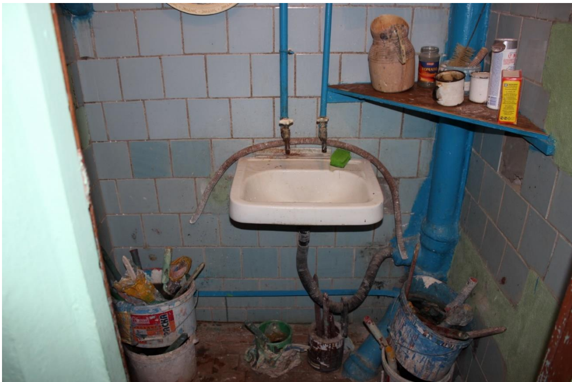
Фото 3. Техническое состояние инженерных коммуникаций
