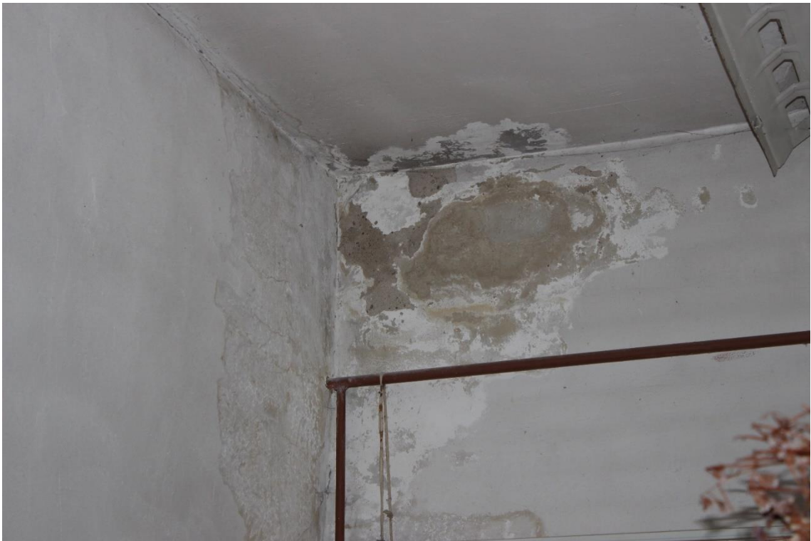
Фото А.7. Разрушение отделочного слоя в помещениях здания
