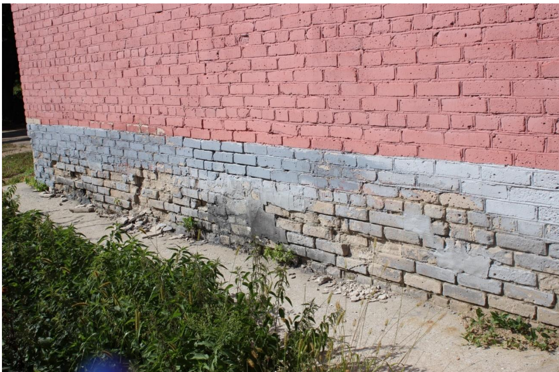
Фото 22. Разрушения кирпичной кладки в цокольной части стены
