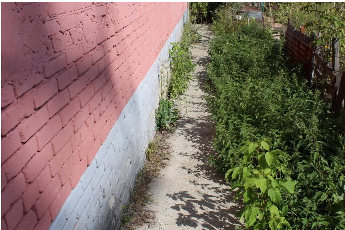
Фото 23. Прорастание растительности в стыках между отмосткой и стеной. Нарушение горизонтальной гидроизоляции
