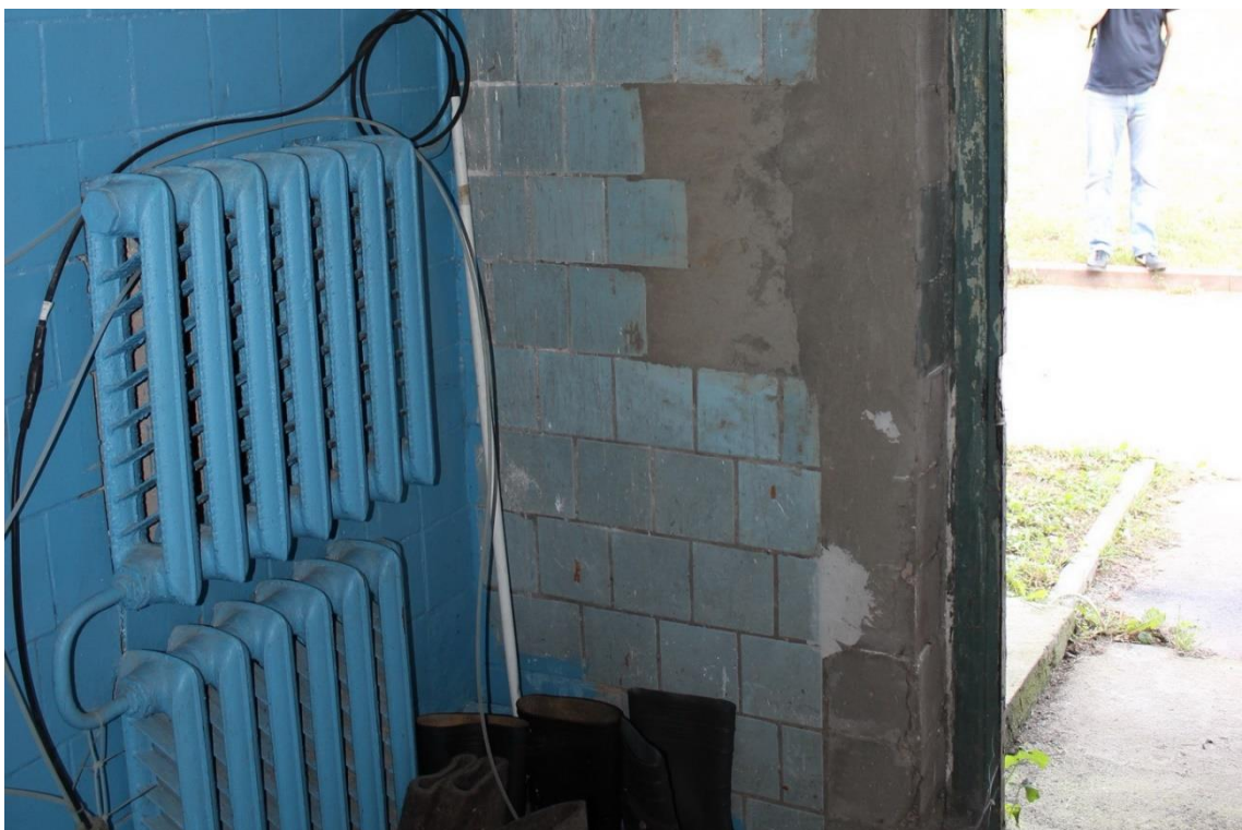
Фото 2. Разрушение отделочного слоя наружных стен изнутри
