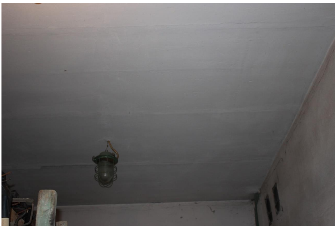
Фото А.2. Техническое состояние междуэтажного перекрытия
