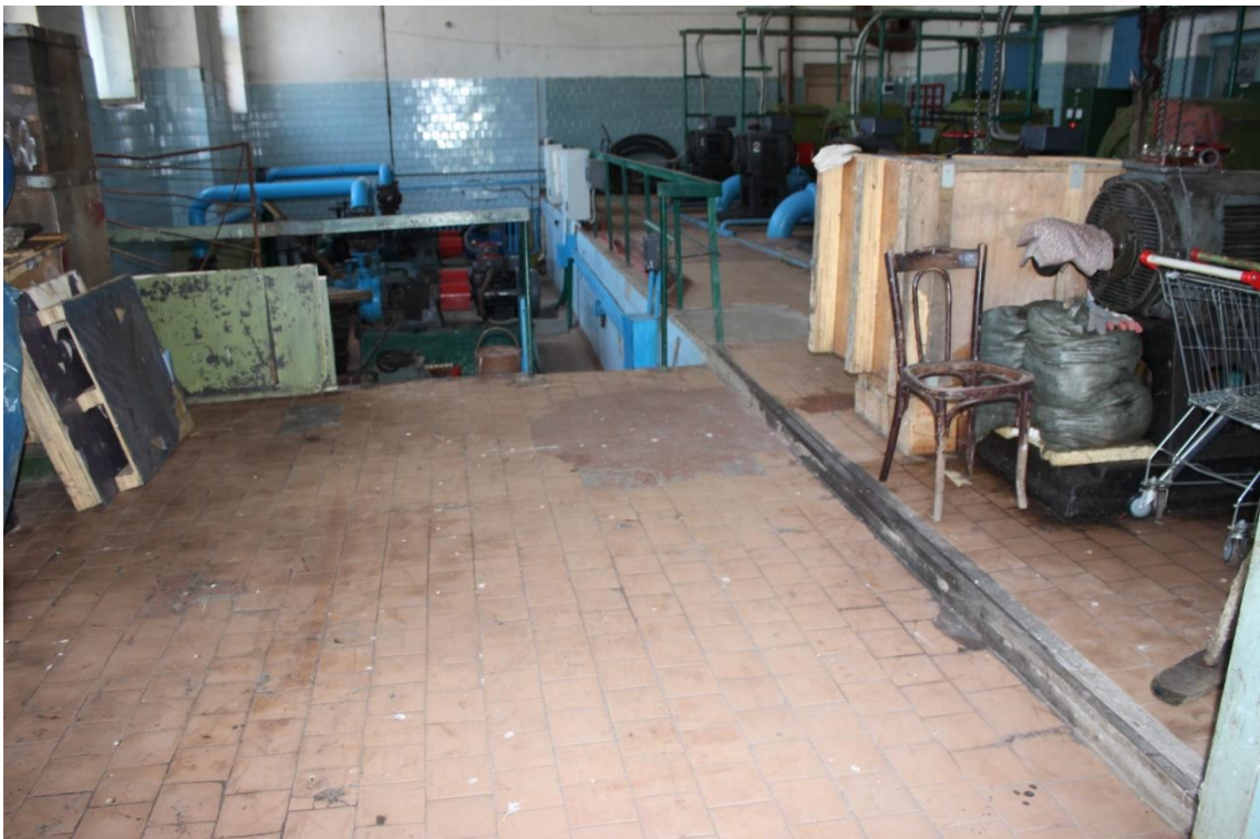
Фото А.18. Техническое состояние пола производственного зала
