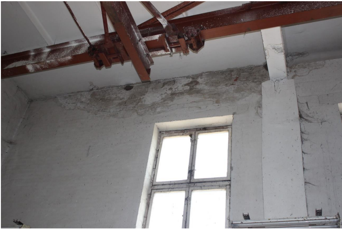
Фото А.15. Последствия длительного замачивания наружной стены в результате протечек кровли
