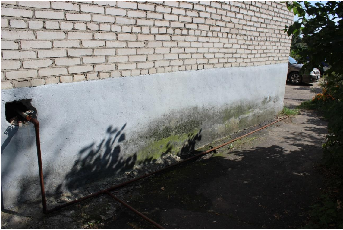
Фото А.33. Замачивание цокольной части стены
