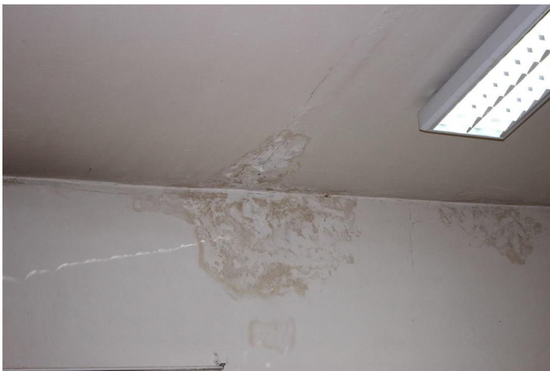
Фото А.6. Следы замачивания внутренних строительных конструкций
