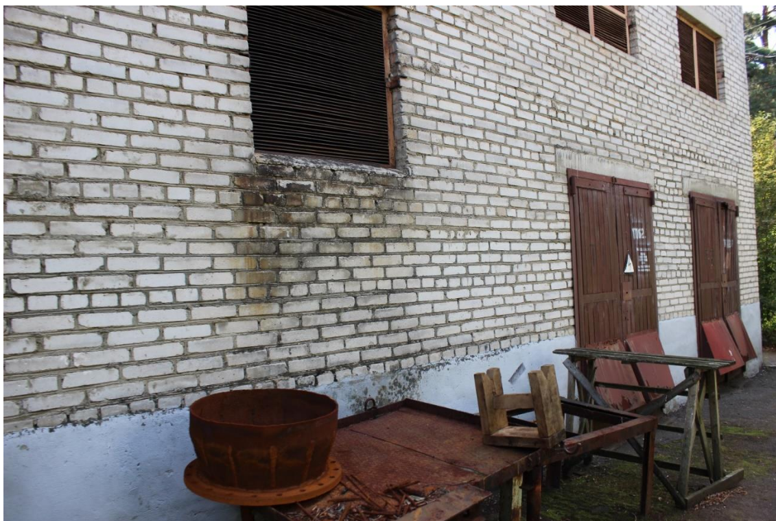
Фото А.33. Отсутствие подоконных сливов. Замачивание стены
