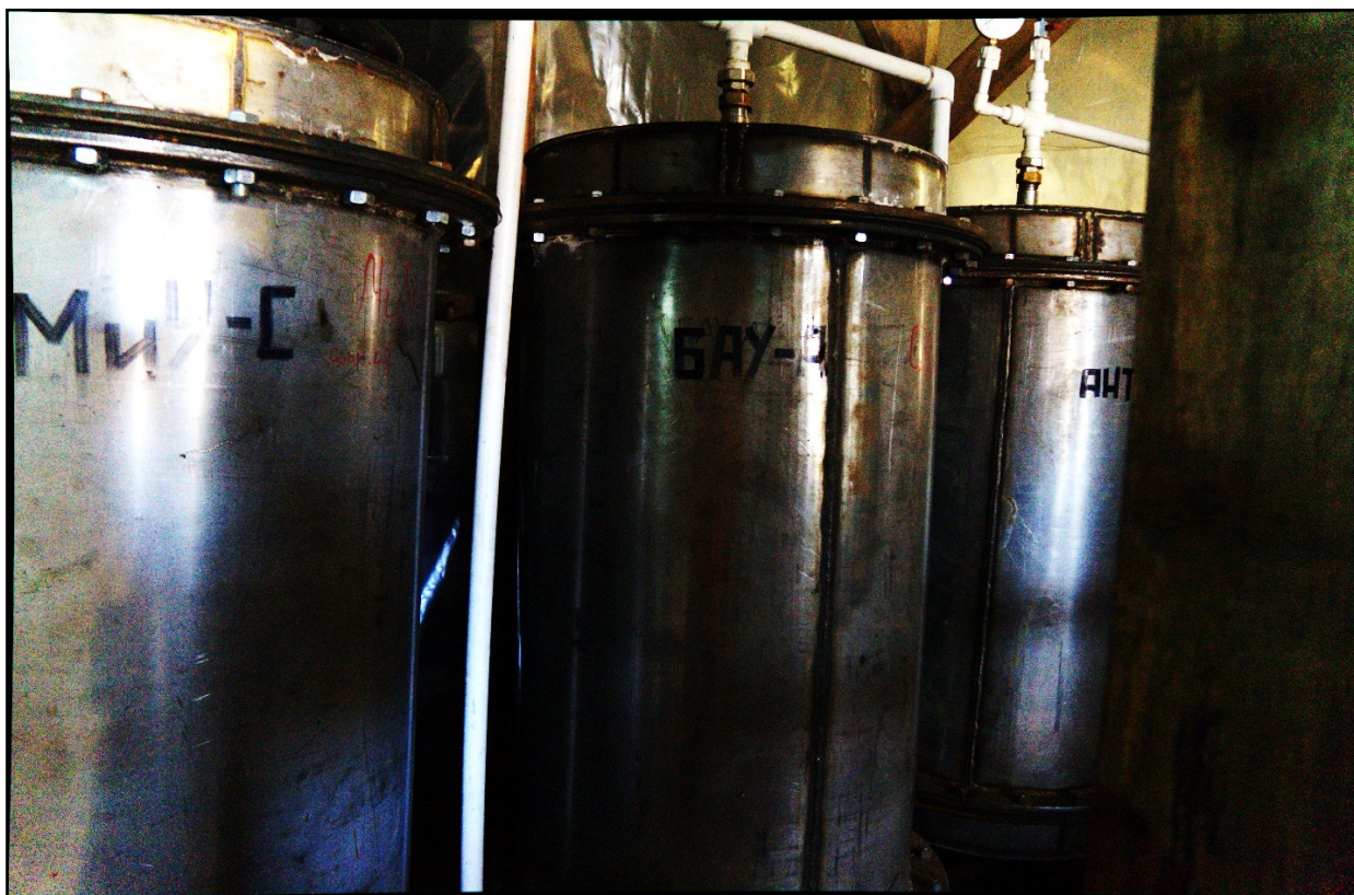
Рис. 5. Блок фильтров для очистки воды
