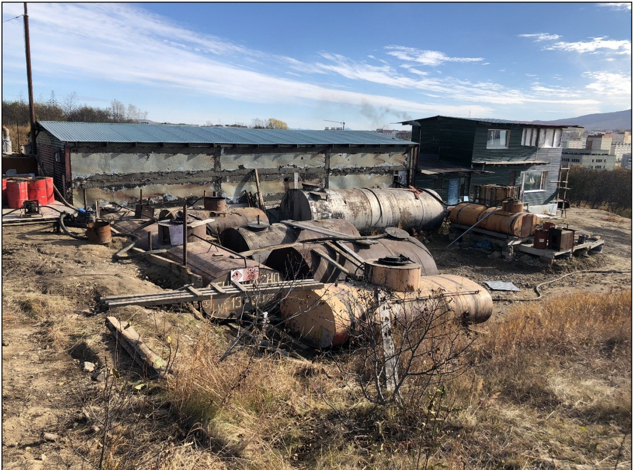
Рис. 2. Резервуарный парк хранения нефтепродуктов
