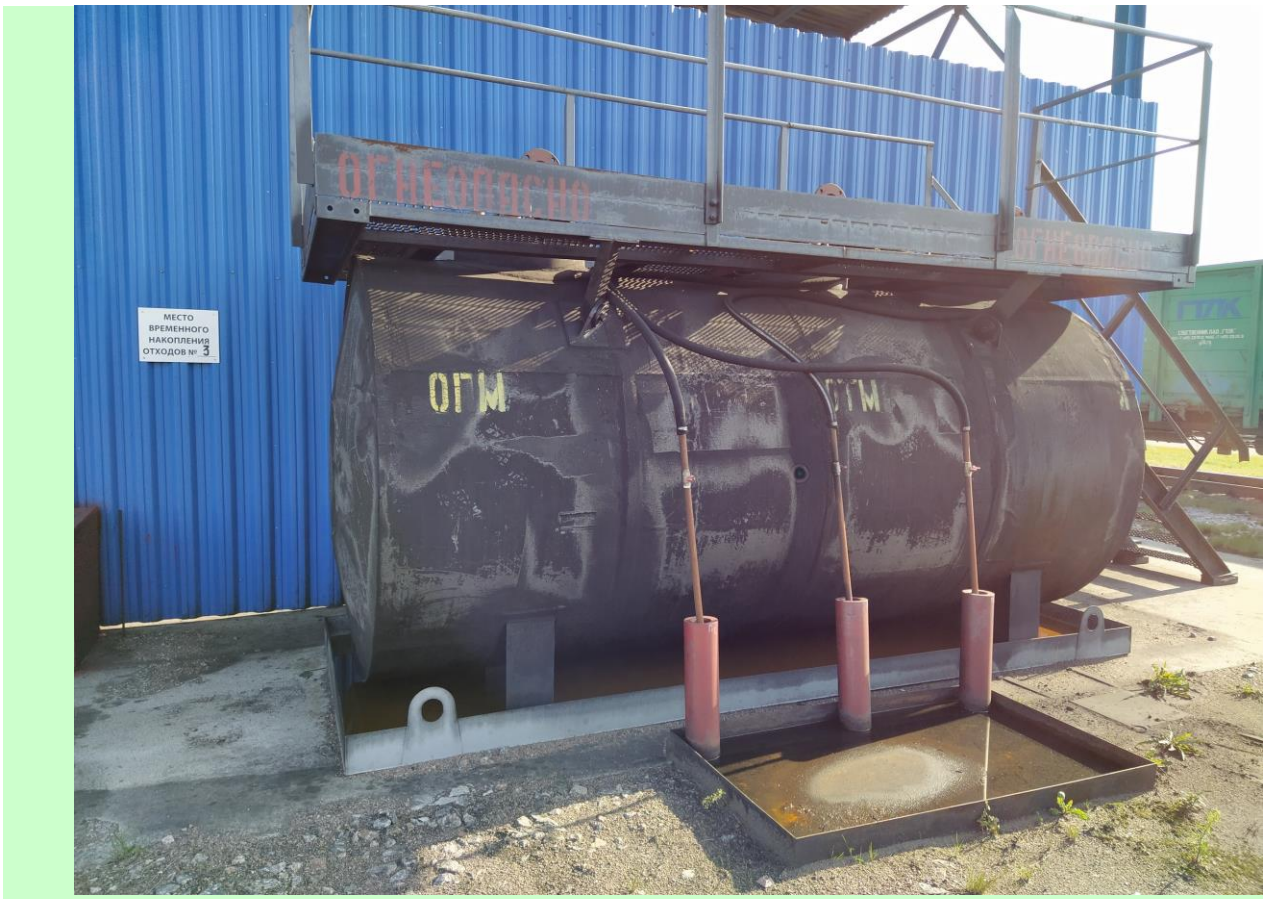
Рисунок 5.1 - Фотография аварийной цистерны
