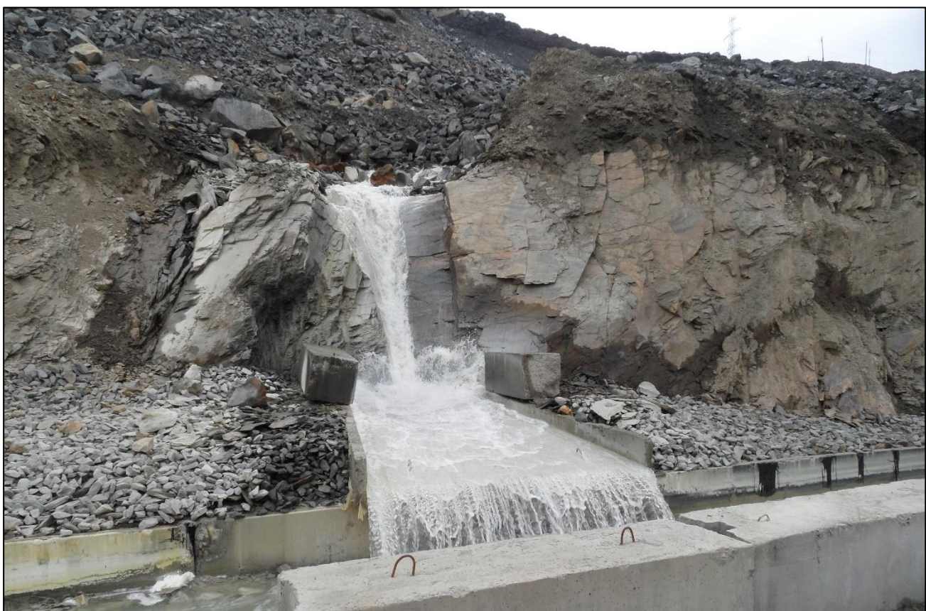
Рисунок 9.3- Общий вид сооружений системы сбора и отведения сточных вод отвала «Восточный» (вид на уровне сооружения)
