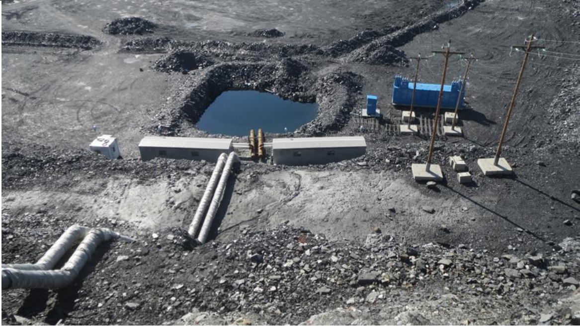
Рисунок 7.33- Забойная насосная станция
