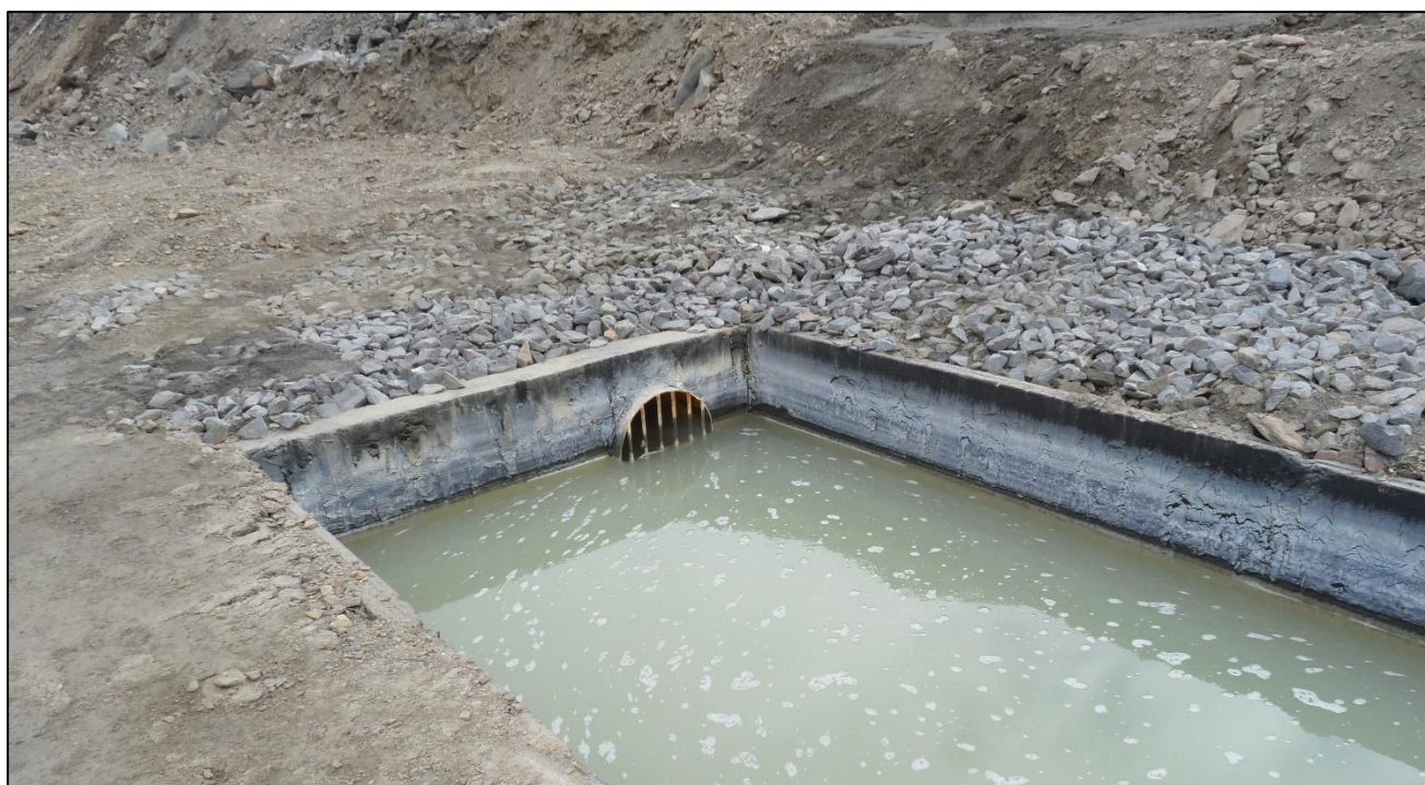
Рисунок 9.4- Входной оголовок самотечного трубопровода DN600 на выпуске из железобетонного канала наклонной бермы гор.+660+650 м северо-восточного борта участка Восточный карьера
