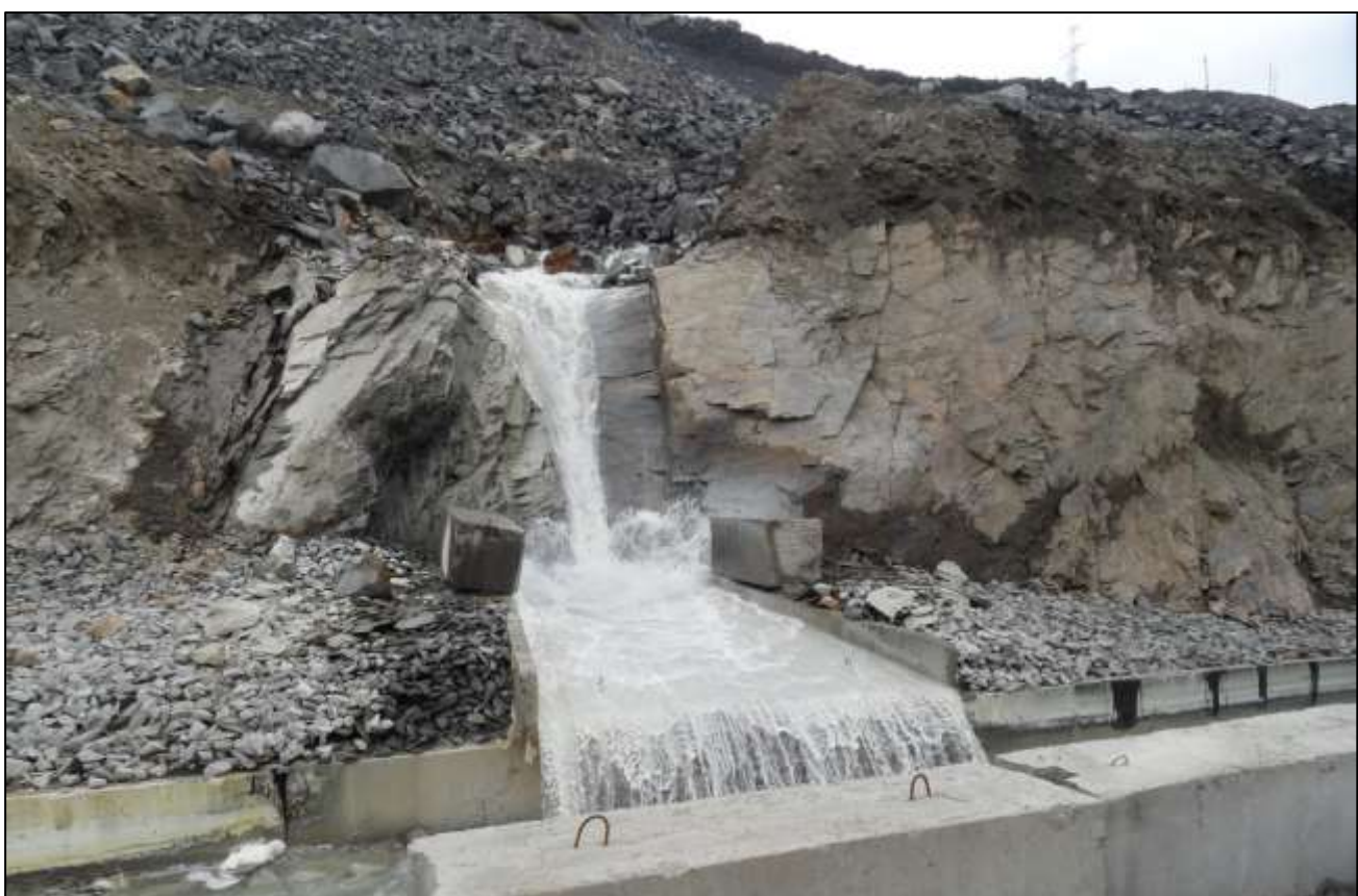
Рисунок 7.2 Система сбора и отведения сточных вод от северо-восточного борта участка «Восточный» карьера (вид на уровне сооружения)
