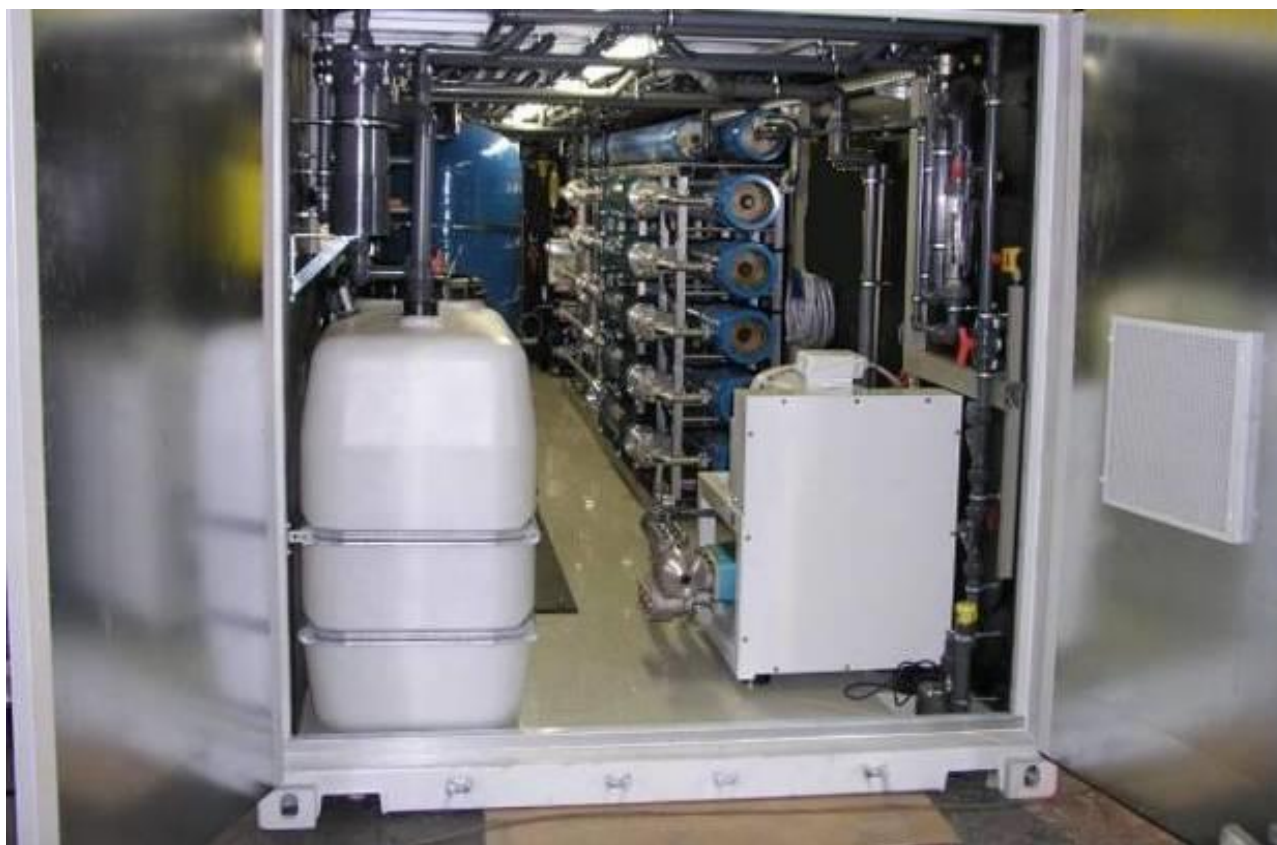
Рис. 2.4. Вид оборудования внутри контейнера
