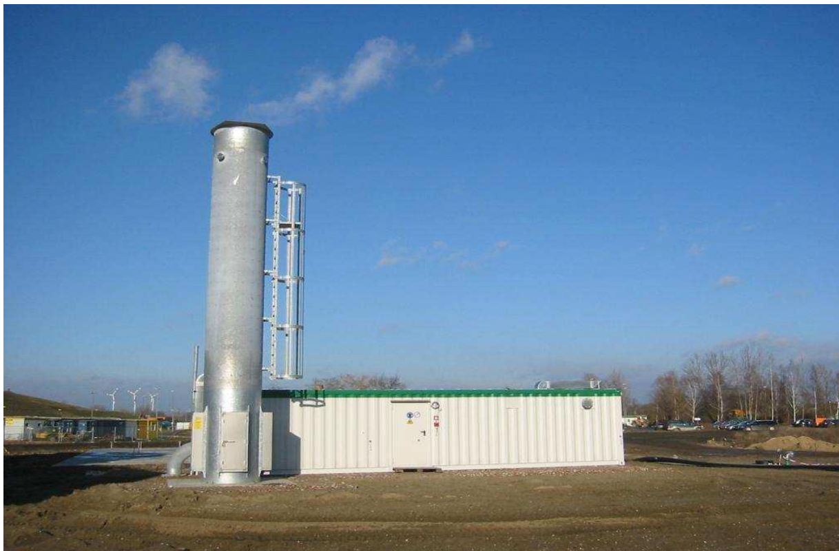
Рис. 2.2. Внешний вид газокompрессорной (ГКС) и факельной установки (ВТФУ)
