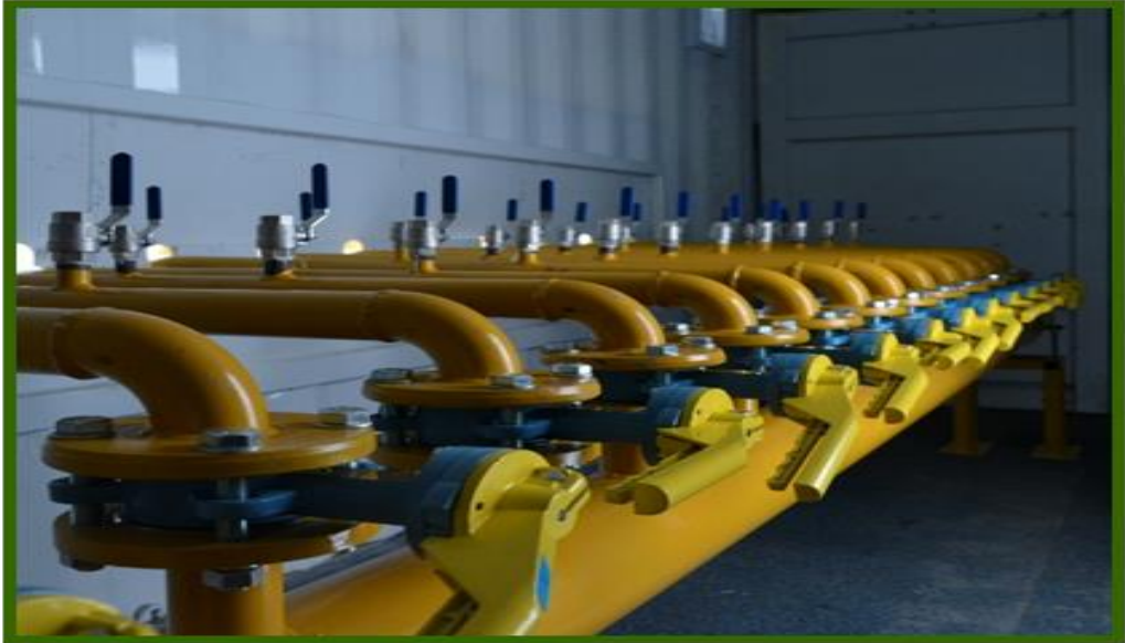
Рис. 19. Газосборная станция (вид внутри)
