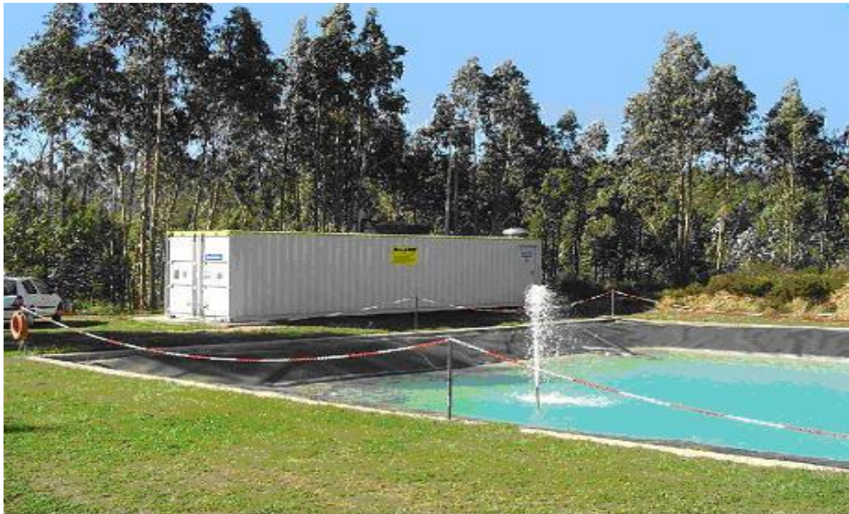
Рис. 9. Внешний вид установки очистки фильтрата обратный осмос.
