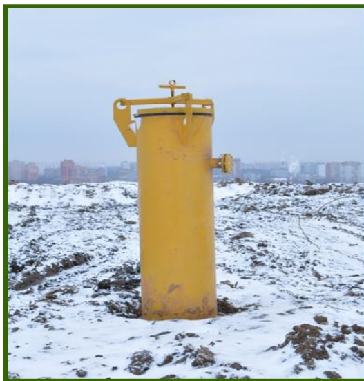
Рис. 18. Внешний вид газодренажной скважины с оголовком
